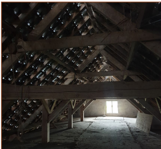
Afb. 2.3: De zolder van de veeschuur. Het dak bevat en pannendak zonder dakbeschot. Hierdoor is het dak ongeschikt voor huismussen en vleermuizen om te dienen als verblijfplaats. Huismusnesten in de schuur ontbreken.
