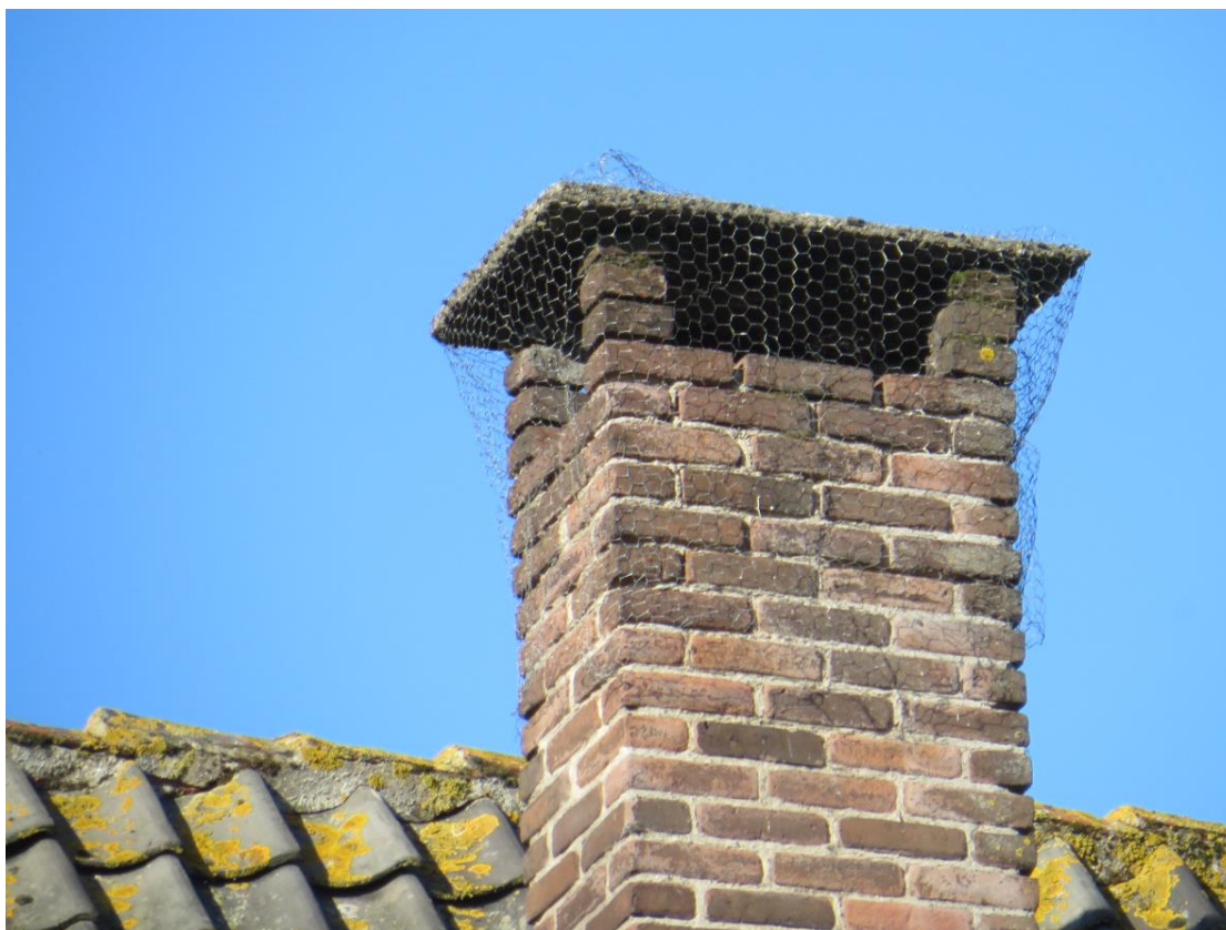
Foto 9. Schoorsteen afgedekt met gaas.
