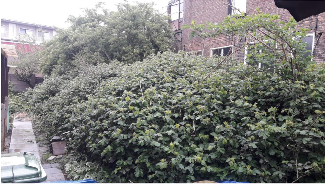
Foto 3. Veel woekerende struiken, oude muur met scheuren.
