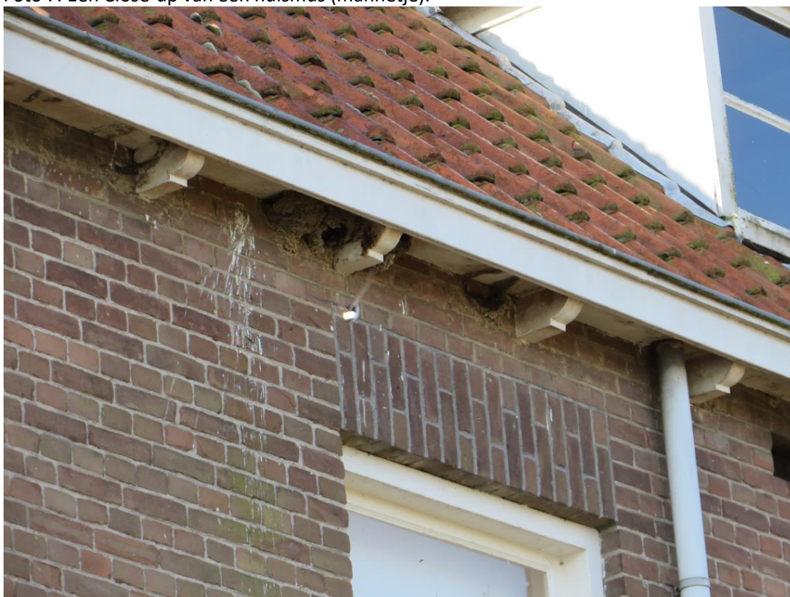
Foto 8. Achterzijde met gootbetimmering waar huiszwaluwnesten tegenaan zijn gebouwd.
