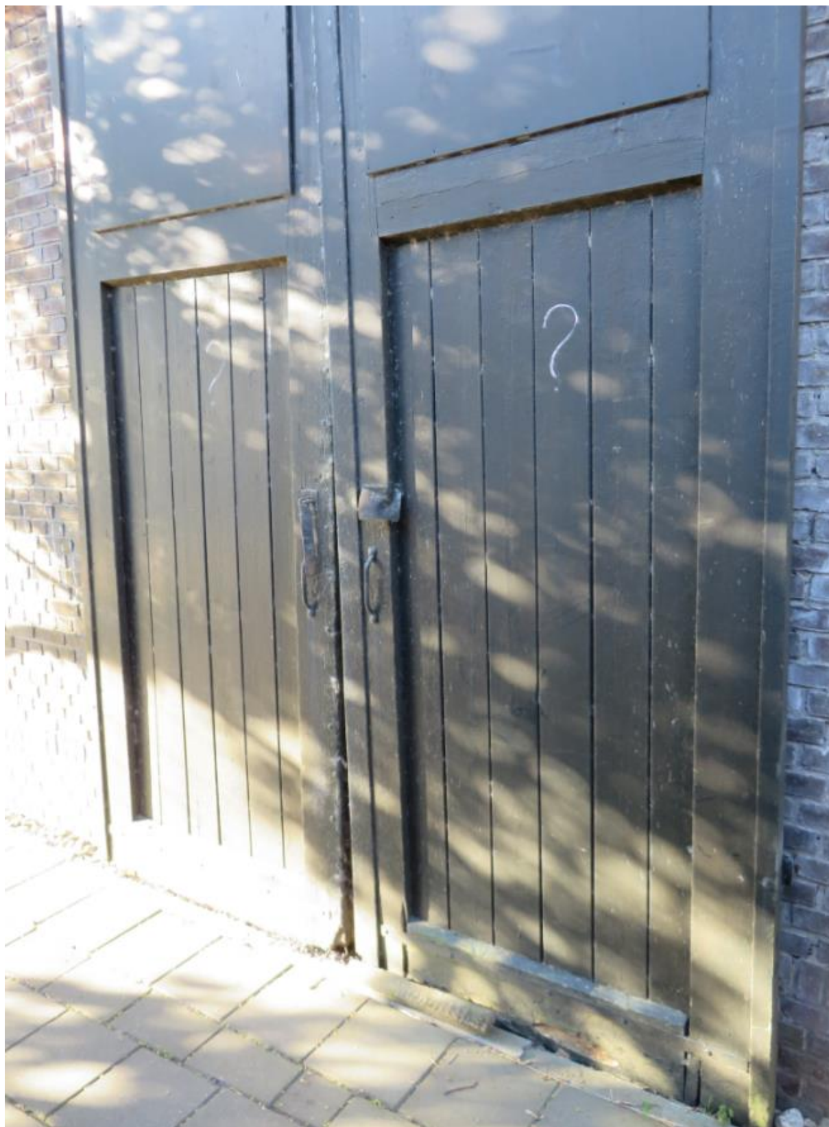
Foto 11. Achterzijde van het pand, oude schuifdeuren die niet afsluiten en zowel boven als onderaan grote kieren hebben.
