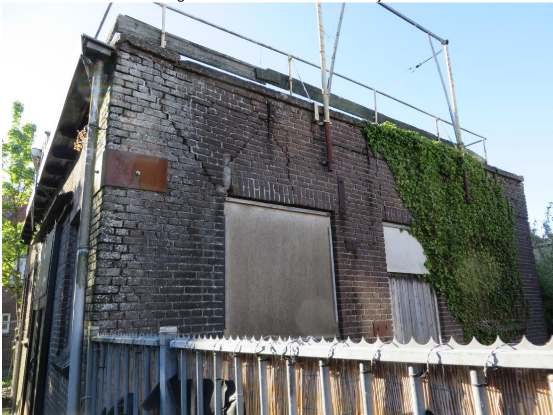
Foto 18. Achterzijde van het pand met dakterras van Veerweg 38, een groene klimplant aanwezig met mogelijk nesten. Daarnaast veel scheuren en kieren waar dwergvleermuizen gebruik van kunnen maken.
