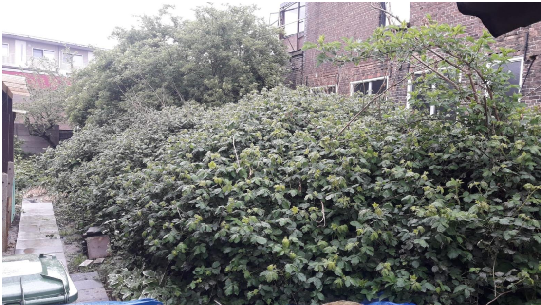
Foto 3. Veel woekerende struiken, oude muur met scheuren.
