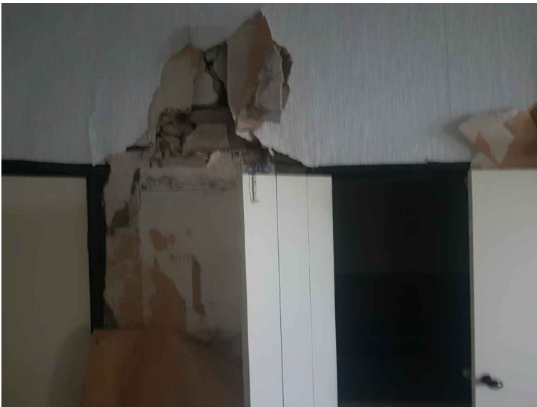
FOTO 0-12 scheuren in tussenmuur, kozijnen doorgezakt
