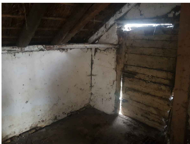
FOTO 0-05 hoek metselwerk verstevigd door stalen strip
