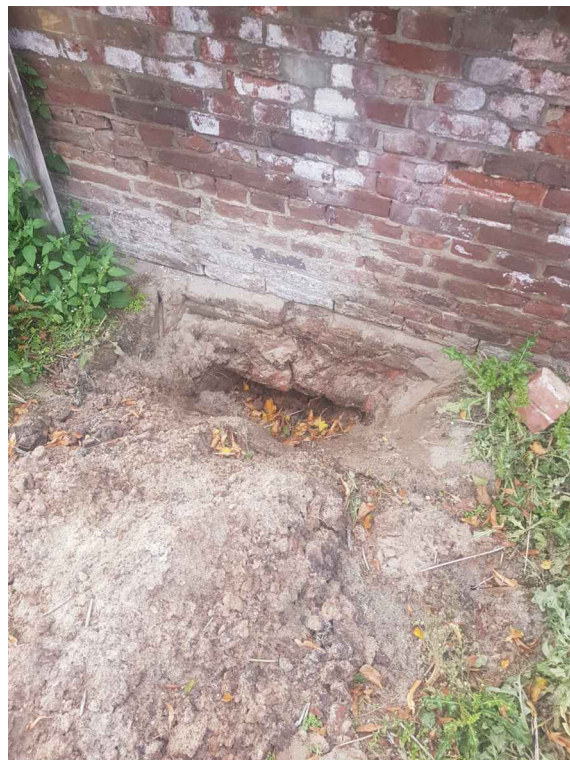
FOTO 19 geen fundering aanwezig muur eindigd ± 300 mm onder maaiveld
