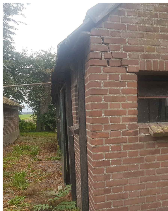
FOTO 1-07 Scheuren in achtergevel tpv rechter zijgevel
