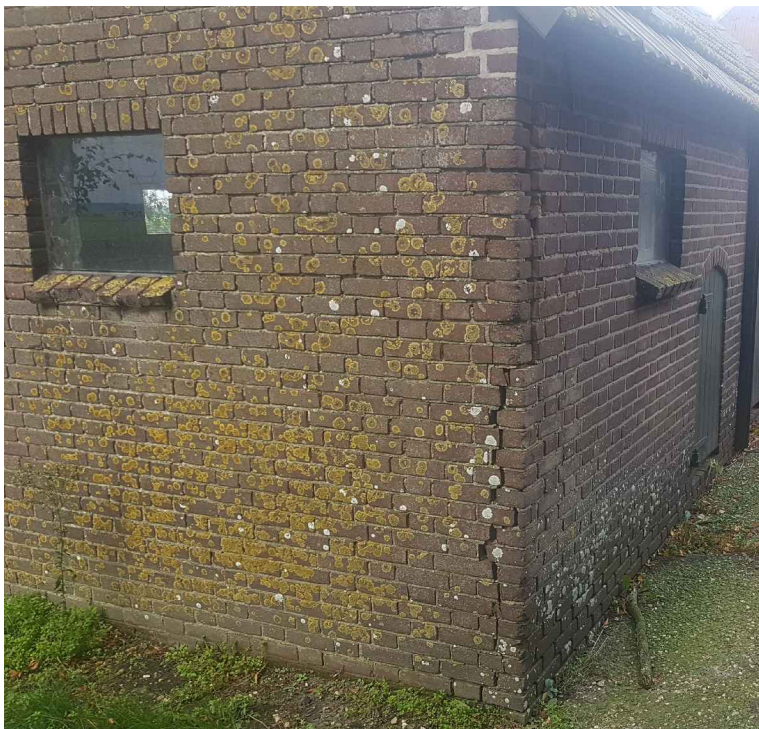
FOTO 1-01 Rechter zijgevel uitgezakt tpv voorgevel, scheur ±10 mm
