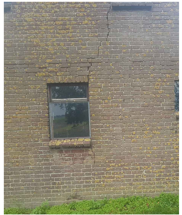
FOTO 1-02 Scheur tpv voorgevel
