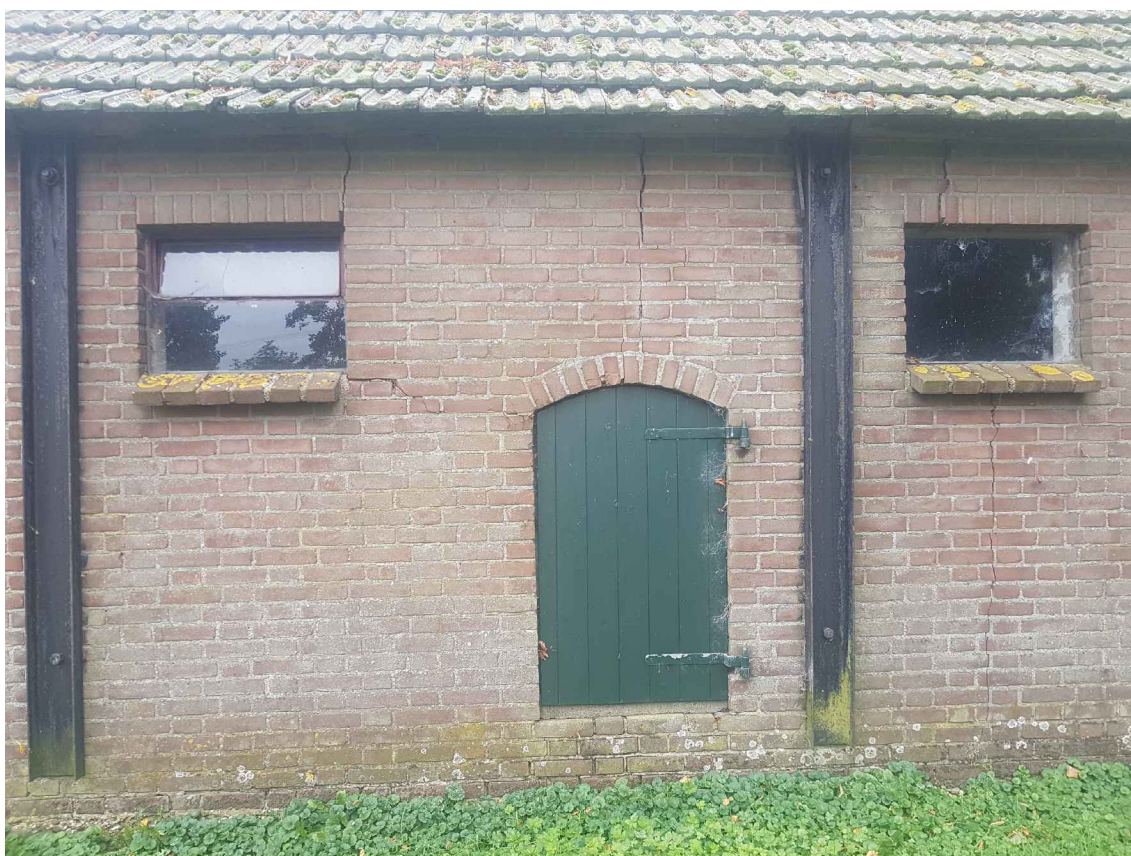
FOTO 1-05 Scheuren in linker zijgevel
