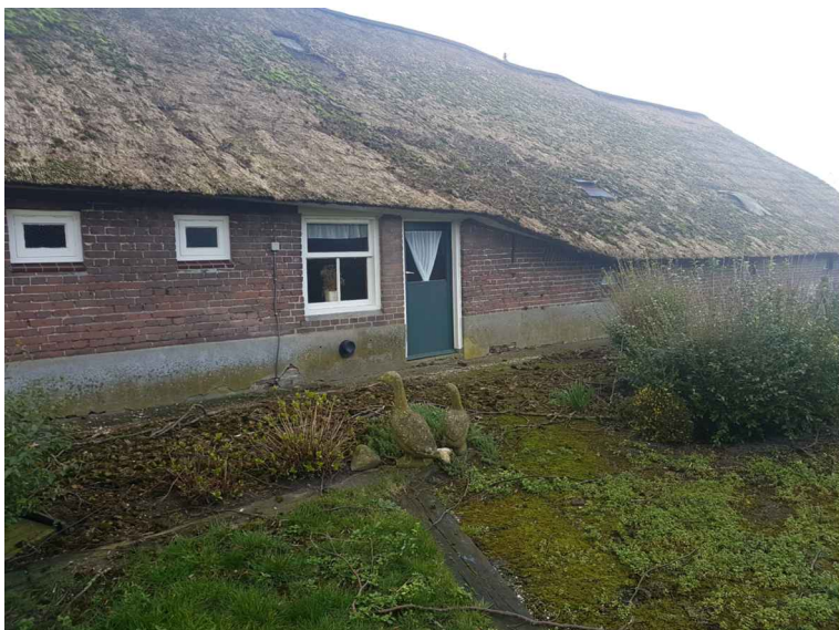
FOTO 24 dak doorzakt riet zeer slecht
