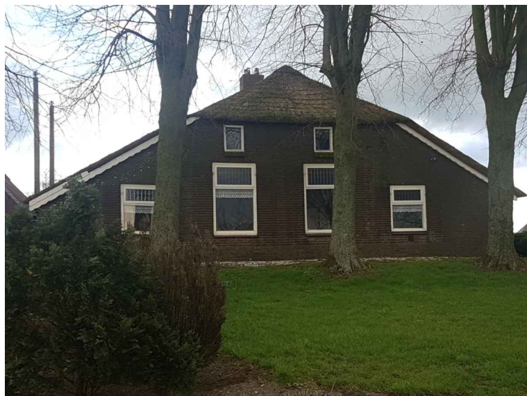
FOTO 02 metselwerk voorgevel ± 1965 rieten kap zeer slecht en doorgezakt
