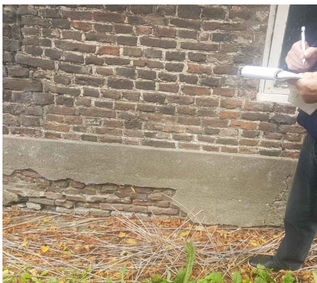
FOTO 05 lambrisering kapot, voegwerk zeer slecht
