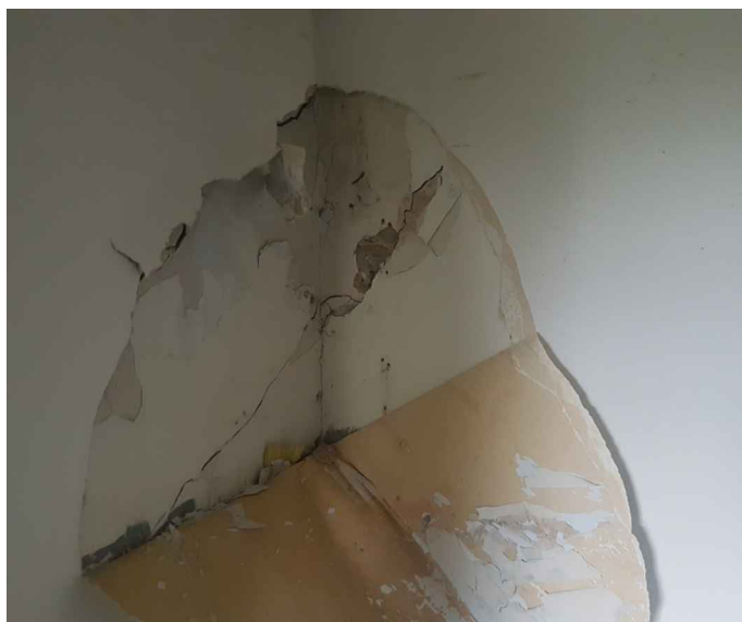
FOTO 0-15 Scheur in tussenmuur
