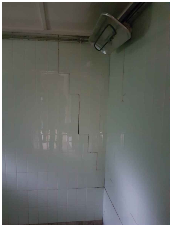
FOTO 0-07 scheuren in badkamer
