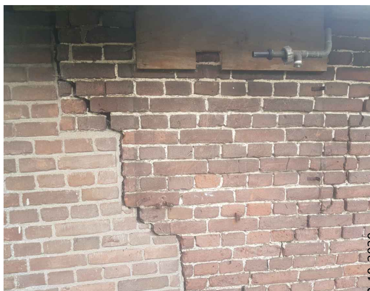
FOTO 27 scheuren in metselwerk
