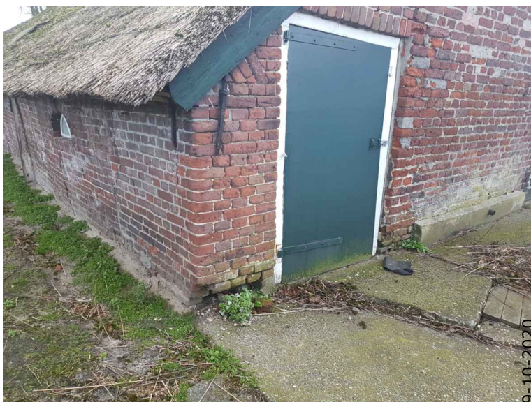
FOTO 17 rieten kap zeer slecht en doorgezakt, zijgevel \pm 300 mm uitgezakt
