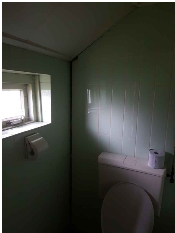
FOTO 0-09 zijgevel doorgescheurd, scheur ±30 mm
