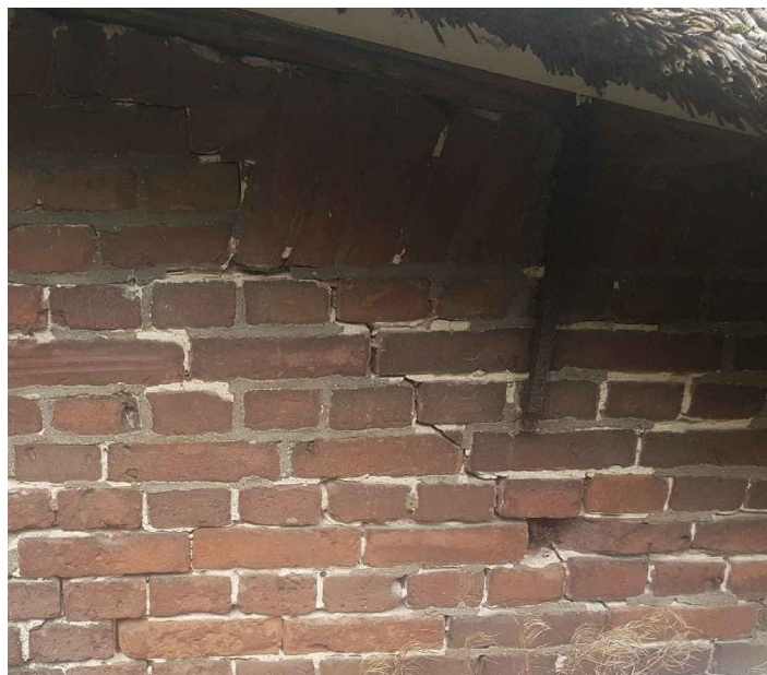
FOTO 23 detail foto 22 scheur in metselwerk
