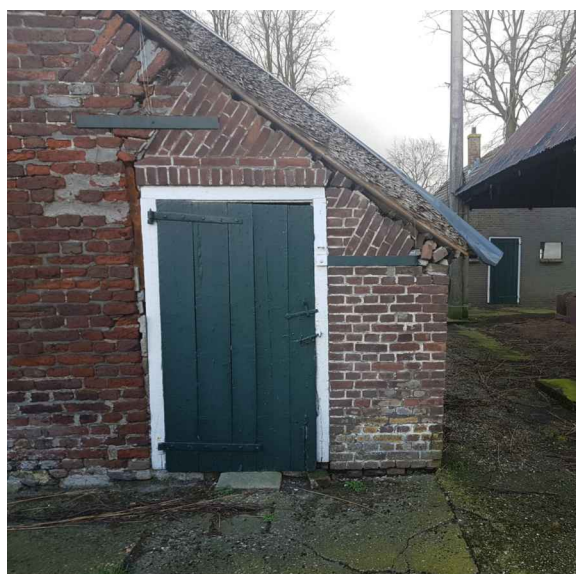
FOTO 13 rieten kap zeer slecht stalen platen om metselwerk in verband te houden
