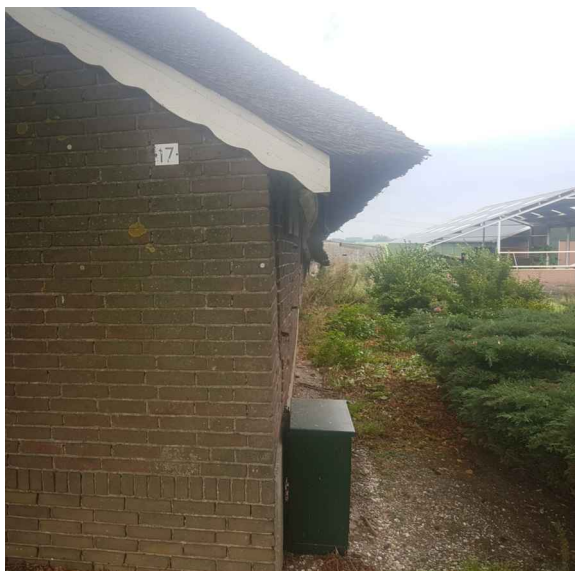
FOTO 01 zijgevel ± 200 mm naar buiten uitgezakt
