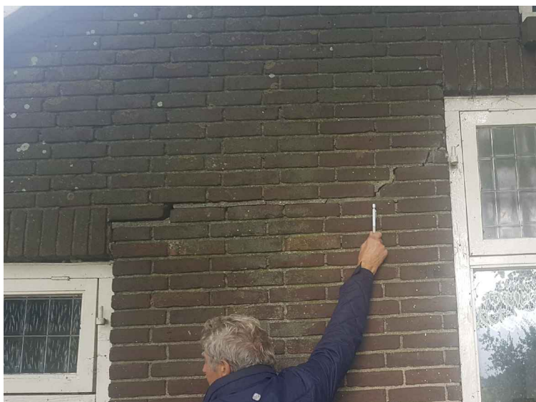
FOTO 03 scheur in voorgevel
