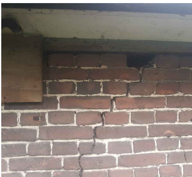
FOTO 26 scheuren in metselwerk, losse stenen onder
