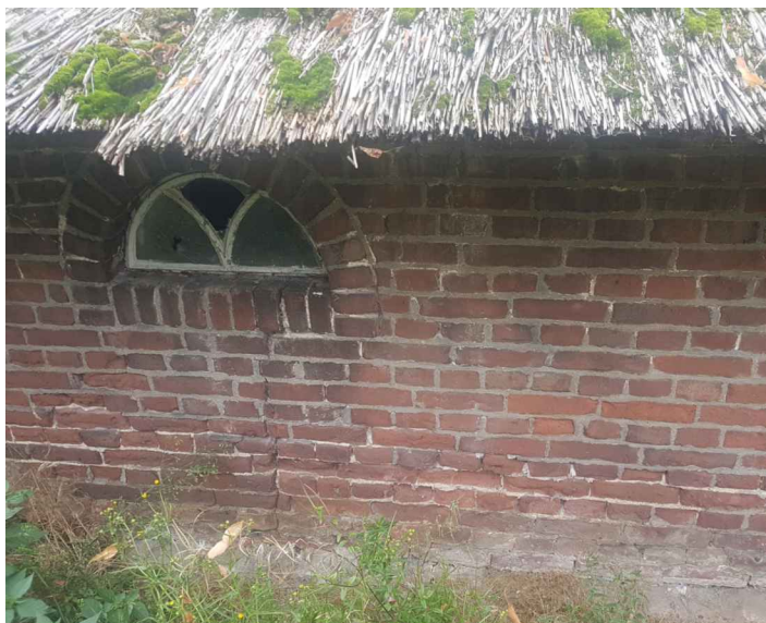
FOTO 20 scheur onder kozijn
