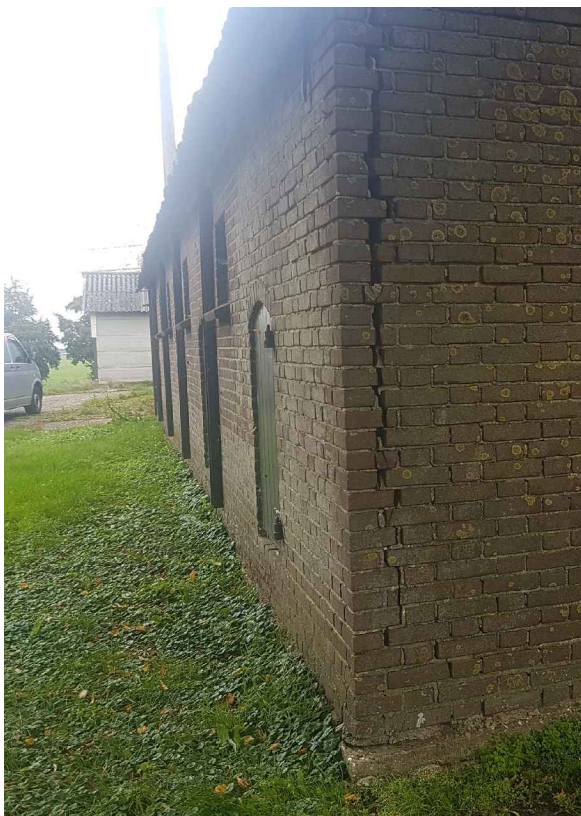
FOTO 1-03 Linker zijgevel uitgezakt tpv voorgevel, scheur ±10 mm
