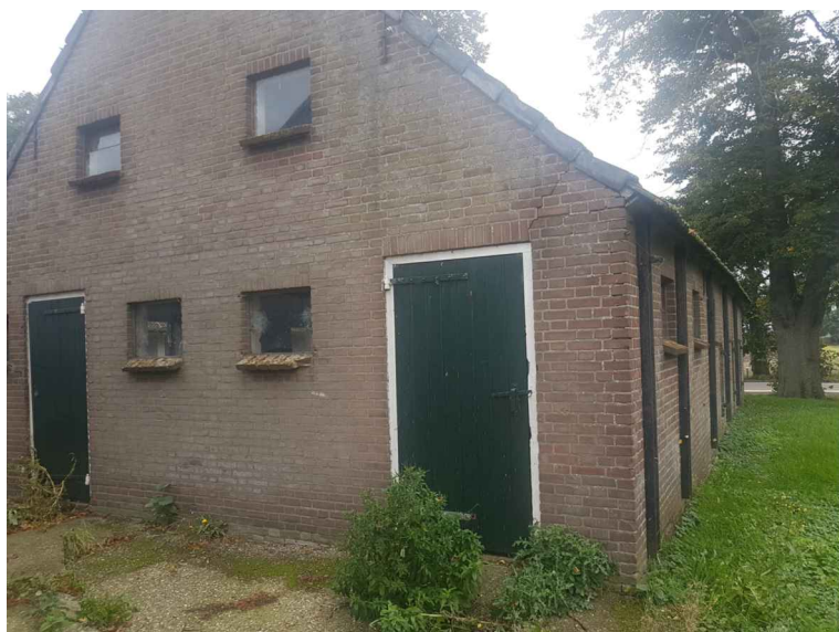
FOTO 1-06 Scheuren in achtergevel tpv linker zijgevel
