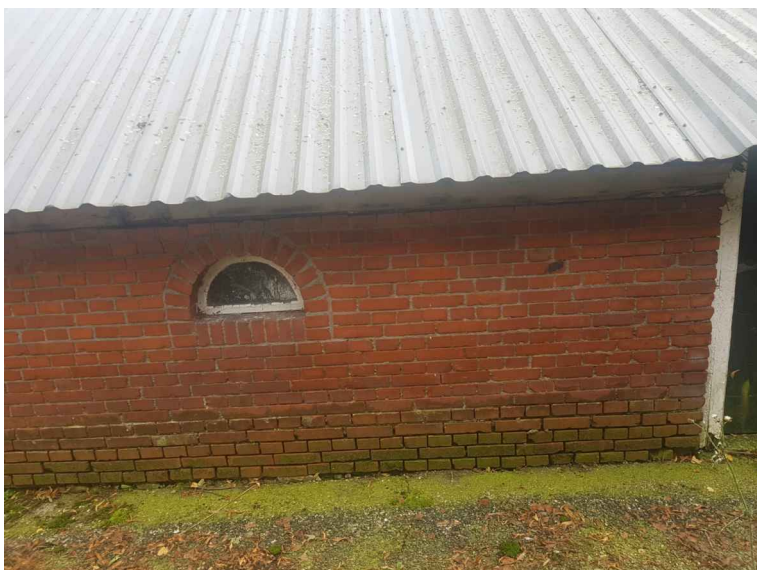
FOTO 11 zijgevel metselwerk van ± 1965 zeer slecht voegwerk
