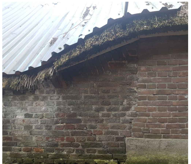
FOTO 08 rieten kap zeer slecht en doorgezakt stalen platen om dak dicht te krijgen
