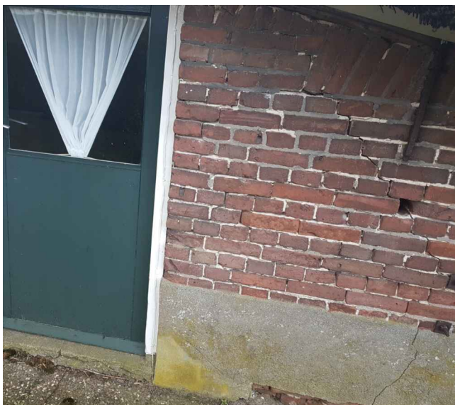
FOTO 22 scheur in metselwerk
