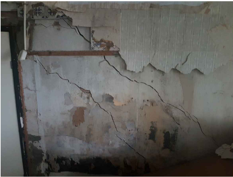
FOTO 0-11 detail foto 10 scheuren in tussenmuur
