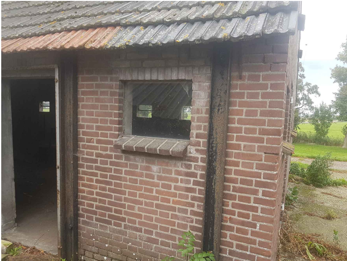
FOTO 1-08 Rechter zijgevel uitgezakt, ondersteunt door staalprofielen ter voorkoming van instorten
