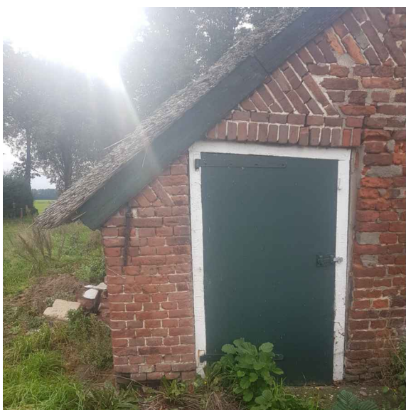
FOTO 16 kozijn ernstig verzakt, los metselwerk
