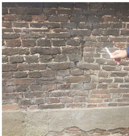
FOTO 06 scheuren in zijgevel
