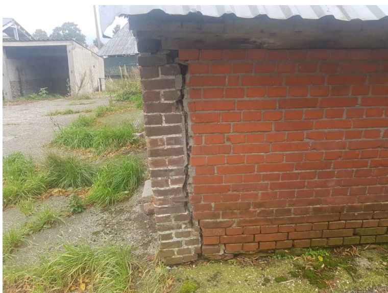
FOTO 12 metselwerk achtergevel uitgezakt, scheur \pm 50 mm
