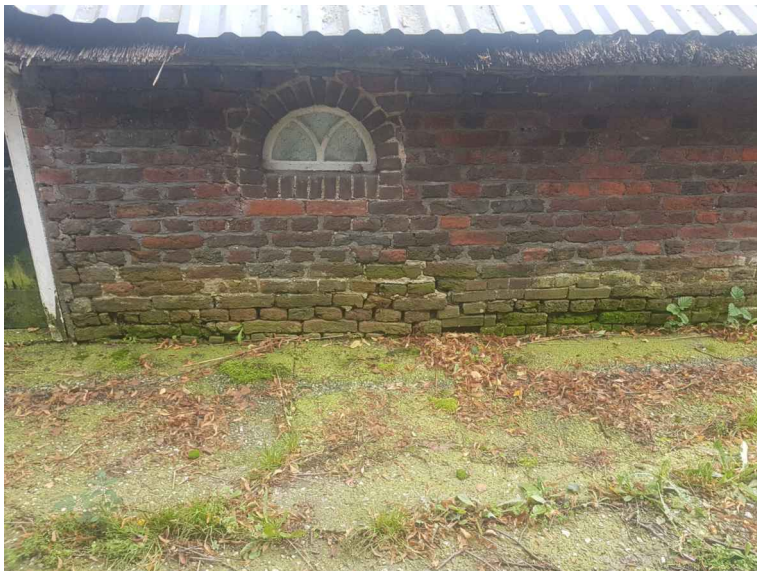
FOTO 09 metselwerk los en zeer slecht voegwerk
