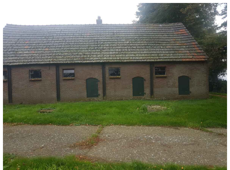
FOTO 1-04 Linker zijgevel uitgezakt, ondersteunt door staalprofielen ter voorkoming van instorten
