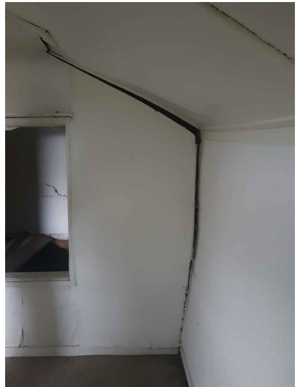
FOTO 0-14 zijgevel uitgezakt, scheur \pm 30 mm
