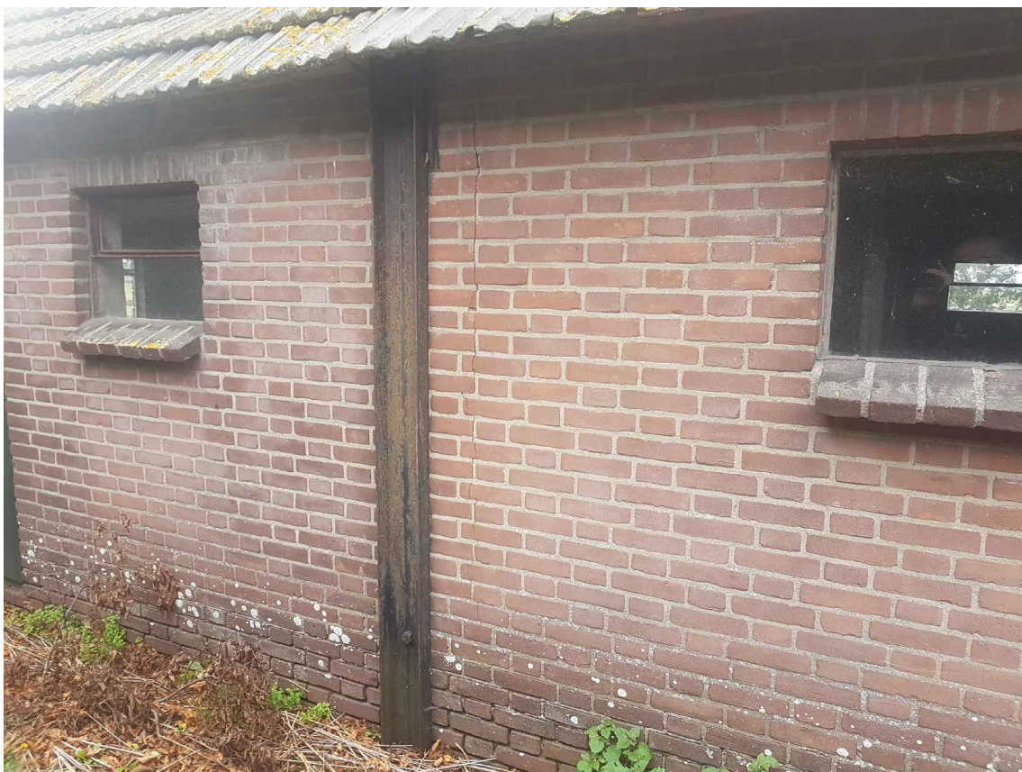
FOTO 1-09 Scheur in rechter zijgevel uitgezakt, slecht voegwerk
