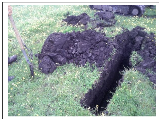
Foto: Inspectiesleuf D02-05
