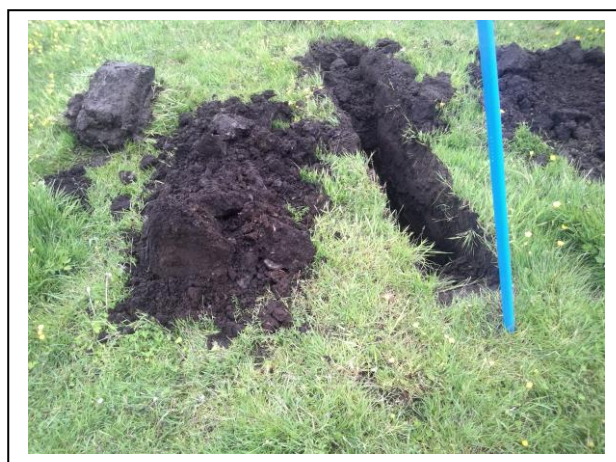
Foto: Inspectiesleuf D03-01
