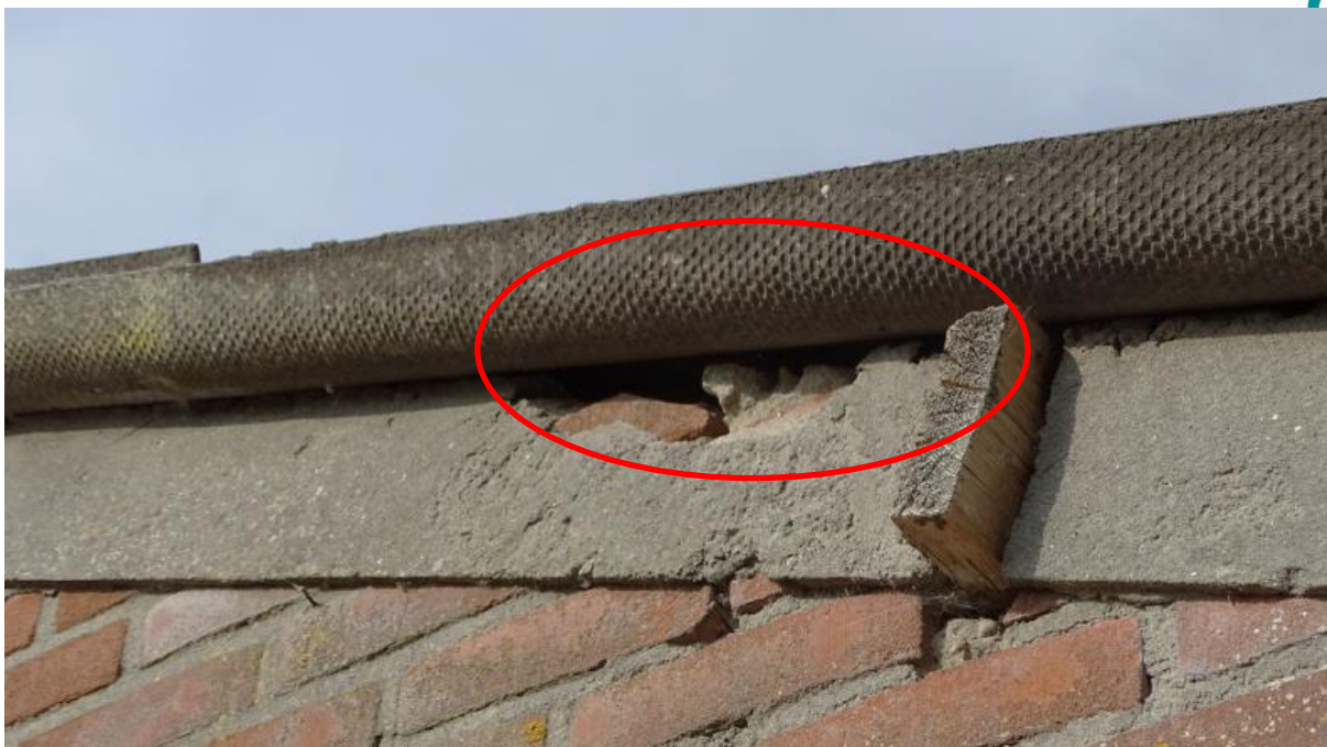
Figuur 5.2. Kapotte stenen en voegen onder de dakrand aan voorzijde schuur, toegangsmogelijkheid tot de spouw.
