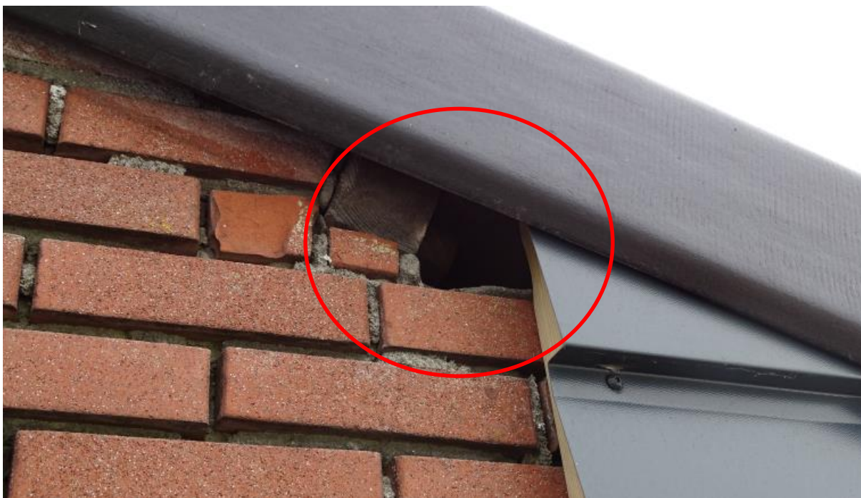
Figuur 5.4. Gat in de muur aan achterzijde schuur bij aanbouw van carport, biedt toegang tot de spouw.
