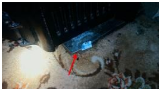
Foto 14 | brandwerende plaat onder kachel
