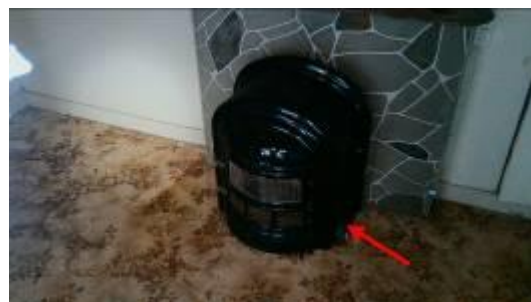
Foto 15 | brandwerende plaat onder kachel
