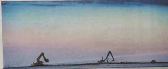
Rijkswaterstaat heeft in het Ketelmeer en het Zwarte Meer twee nieuwe eilanden aangelegd. foto Freddy Schinkel
