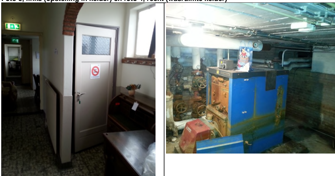
Foto 3, links (opstelling in kelder) en foto 4, recht (wasruimte kelder)
