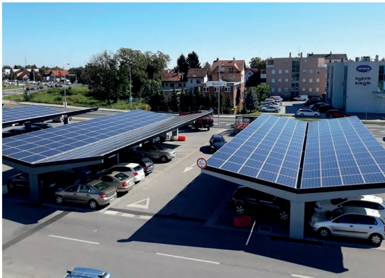
Zonnepanelen boven parkeerplaatsen
