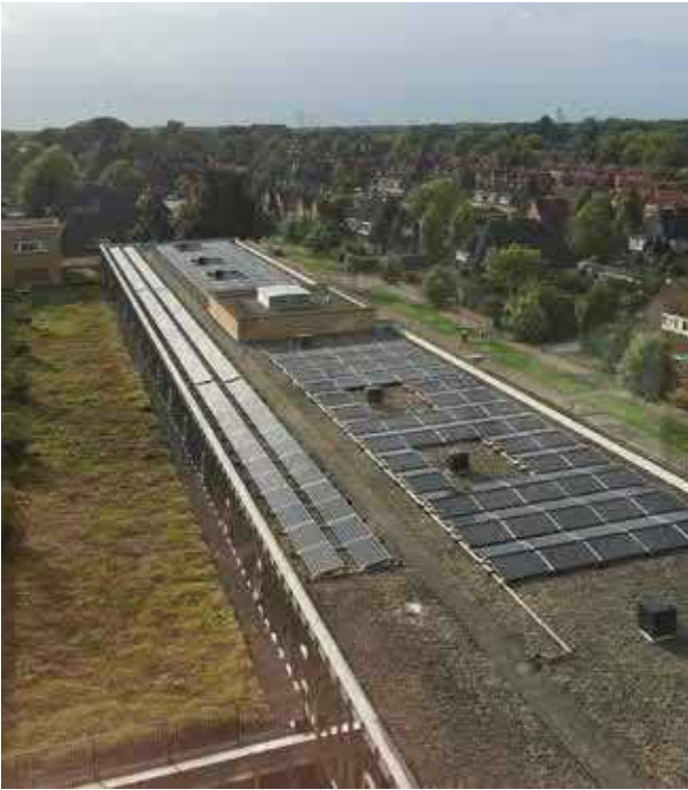
Zonnepanelen op het dak van de Klokstee van het Zonnecollectief Tuindorp
