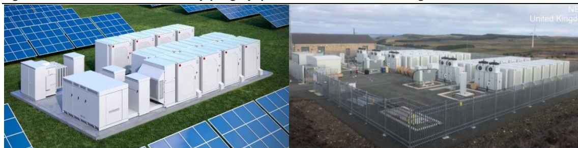
Figuur 6 Referentiebeeld batterijopslag bij opwekinstallatie duurzame energie
