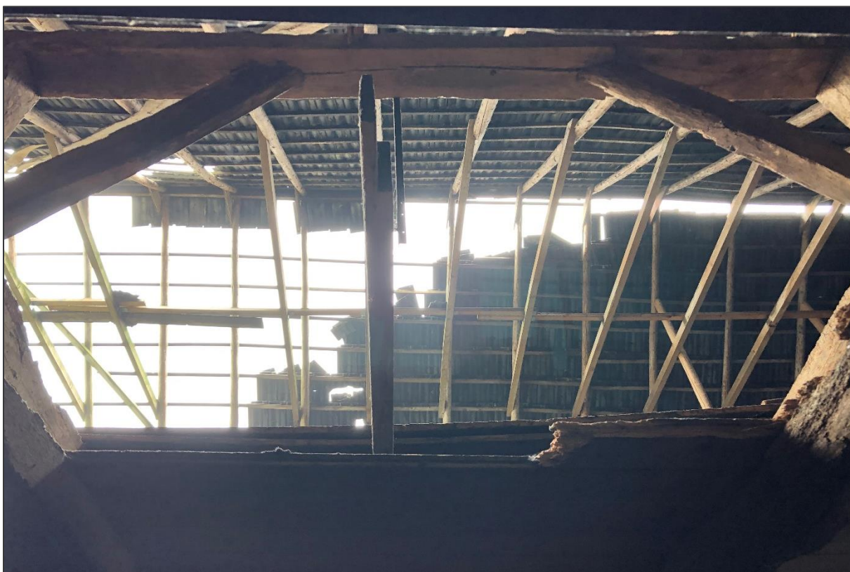
Afbeelding 4c. Impressieplangebied op 23 november 2021. Gat in dak van de schuur van binnenuit.
