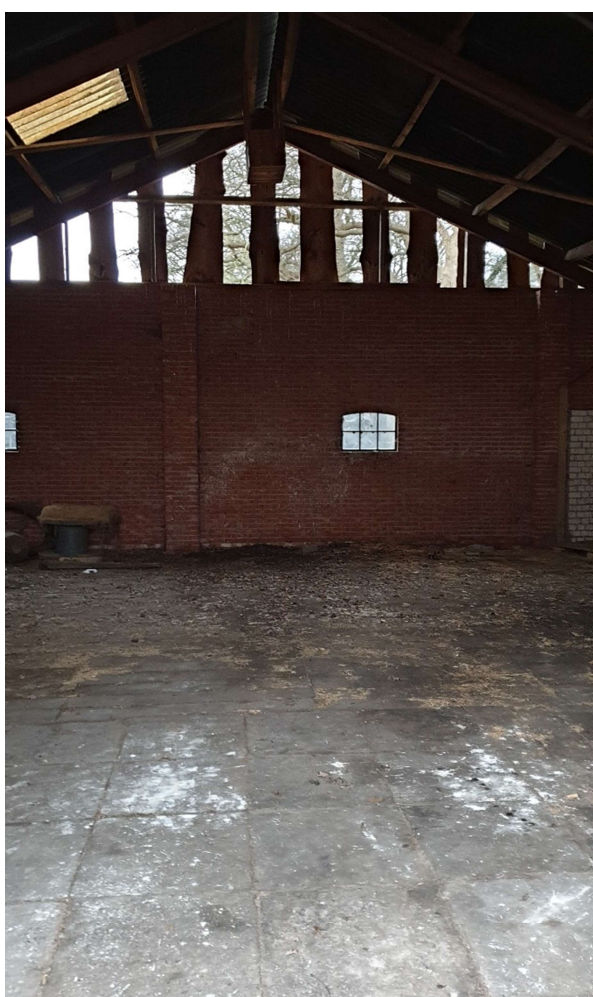
Foto 9: Binnenzijde werktuigenloods met sporen ontlasting kerkuil
