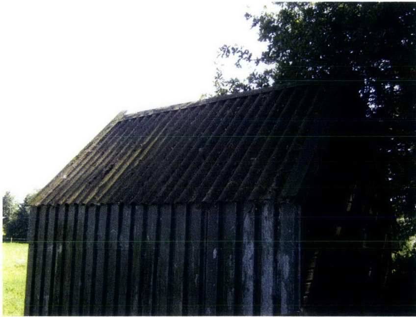
Foto: Schuur met asbestverdacht dak
