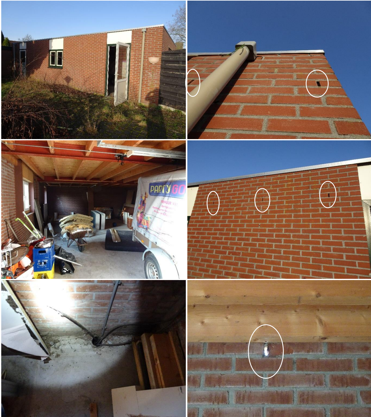
Figuur 9 Actuele situatie ter hoogte van de garage op het terrein van de Wilhelminastraat 58 te Nijverdal. Het is een garage met een plat dak waarbij de open stootvoegen (rechter rij foto's) toegang bieden tot de binnenzijde van de garage (geen spouwgevels aanwezig). In de garage zijn geen sporen van gebruik door vleermuizen of andere beschermde soorten aangetroffen. Foto's: Bureau Biota.
