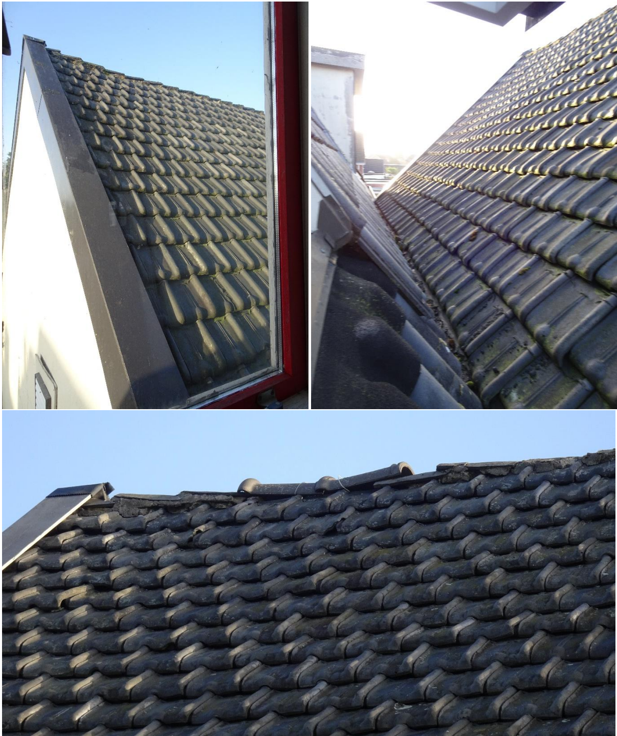
Figuur 13 Actuele situatie van het dak op de schuur. Er zijn met uitzondering van de open nokvorsten geen mogelijkheden voor vogels om onder de dakpannen te geraken (zie onderste foto) en als er al mogelijkheden zijn, dan zorgt de afwezigheid van beplating ervoor dat er geen fundament is voor de aanleg van nesten (zie ook Figuur 7 en Figuur 8) . Foto's: Bureau Biota.
