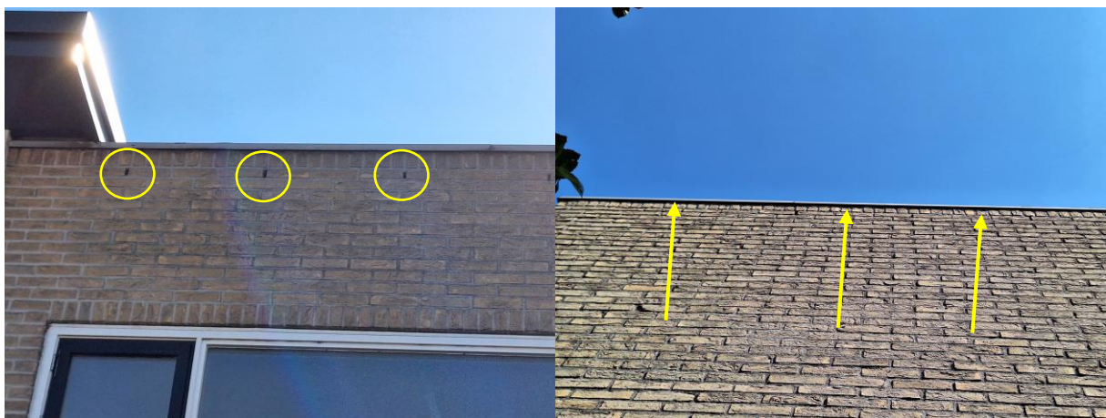
Foto links; openstootvoegen in de buitengevel (gele cirkels). Foto rechts; openingen onder de daklijsten (gele pijlen).
