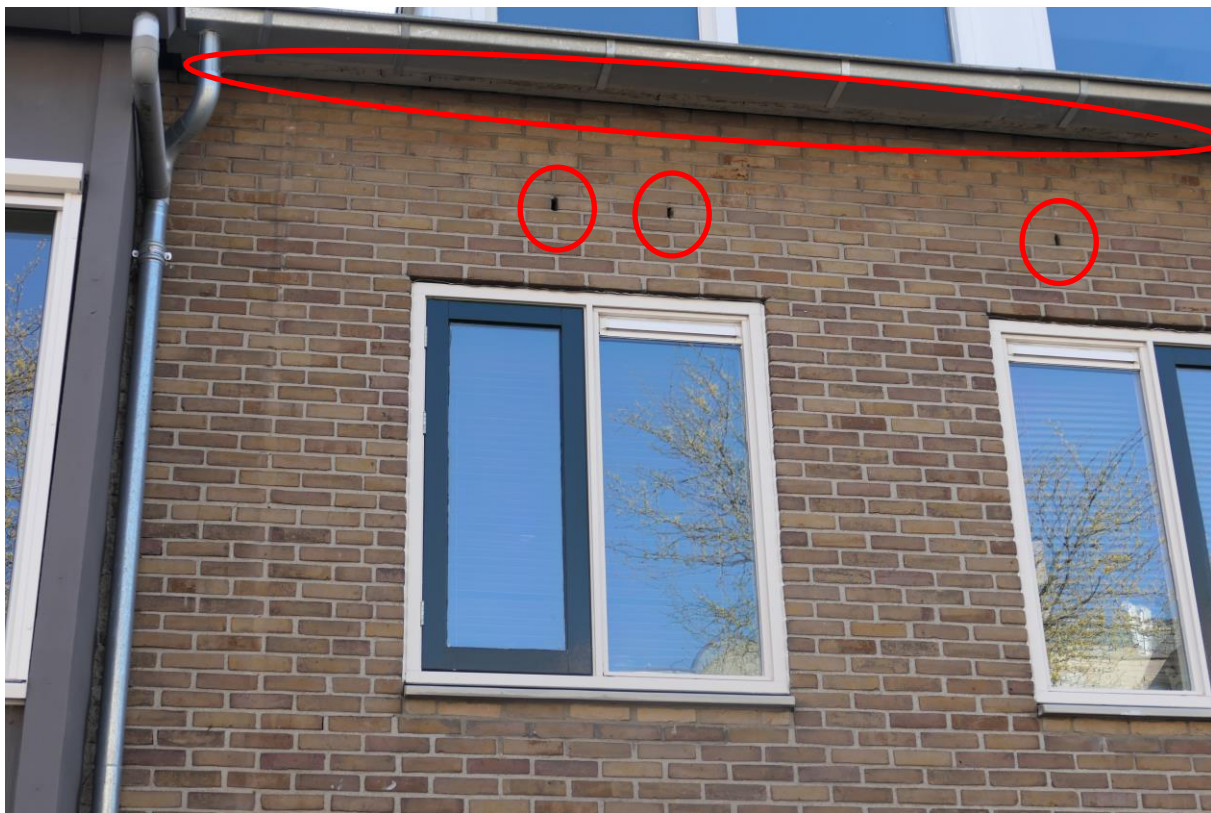
Figuur 4.5 Vleermuizen kunnen toegang tot de woning krijgen via open stootvoegen en via ruimte tussen de gevel en de goot (rood omcirkeld).
