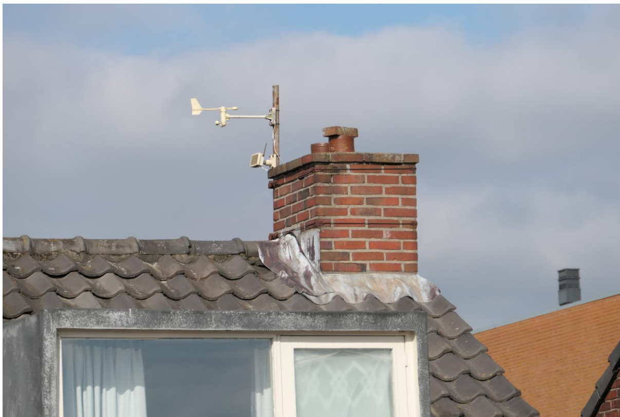
Figuur 4.4 Enkele schoorstenen zijn dichtgezet middels bakstenen. De achterste pijp lijkt toegankelijk.
