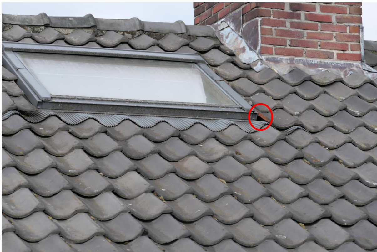
Figuur 4.6 Vleermuizen kunnen toegang tot de woning krijgen via een ruimte tussen een dakpan en het dakraam (rood omcirkeld).
