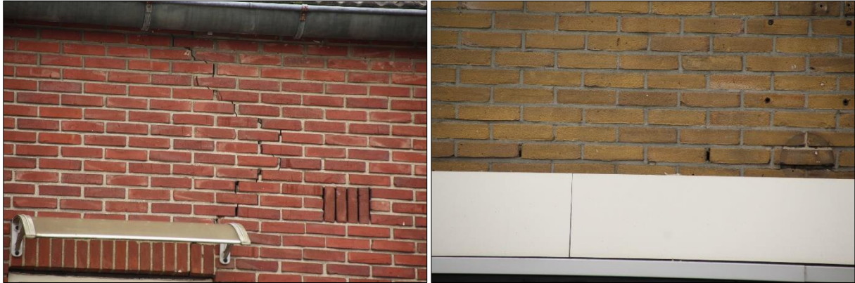
Ventilatieopeningen en open stootvoegen aangetroffen aan de gevels van het pand. Deze bieden vleermuizen de kans een verblijfplaats te bezetten in de spouwmuur.
