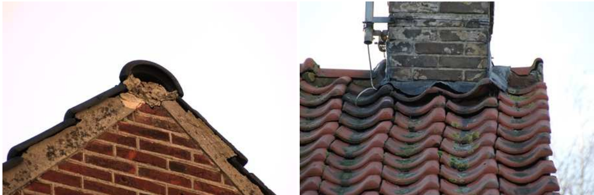
Openingen in het dakvlak. Deze openingen geven vogels zoals de Huismus toegang tot de ruimte tussen het dakbeschoot en de pannen.
