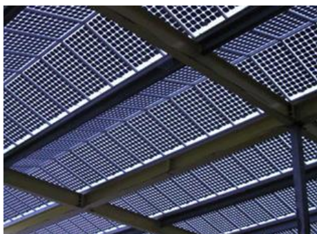
figuur 0.12 Pv-panels als zonwering
