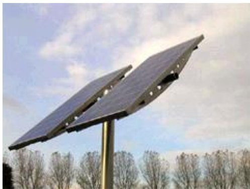
figuur 0.11 Panelen op lichtmast voor eigen energielevering
