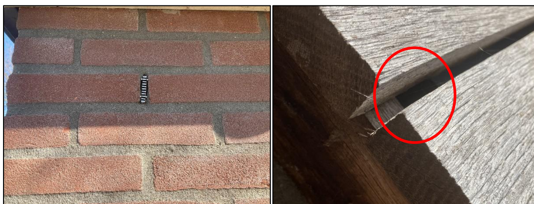
Figuur 6.3 (links): Open stootvoegen in het plangebied voorzien van bijenbekjes; Figuur 6.4 (rechts): Kieren in de gevenbetimmering die mogelijk leiden tot een vleermuisverblijf.
