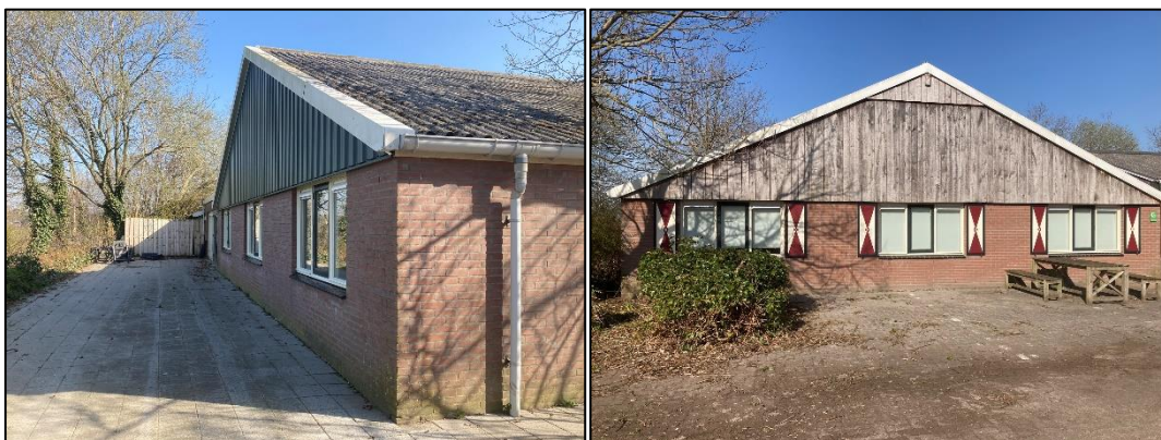
Figuur 2.7 (links): De westzijde van de groepsaccommodatie; Figuur 2.8 (rechts): De oostzijde van de groepsaccommodatie heeft houten gevelbetimmering. Er zitten kieren tussen de houten latten, met daarachter een holle ruimte.
