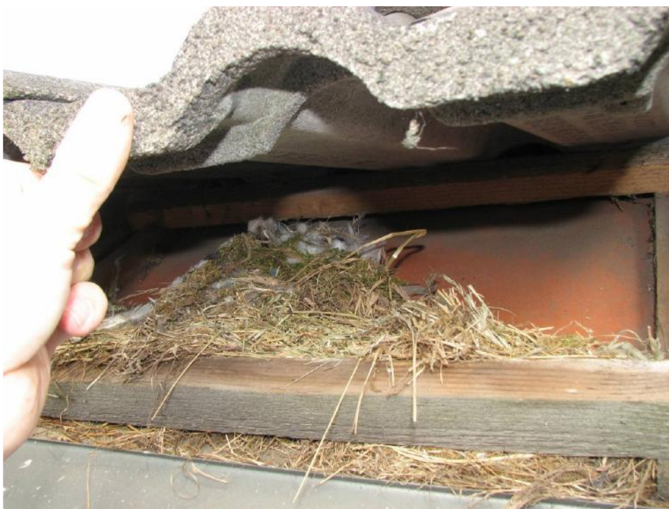
Foto 8: Een nest van de Huismus, onder de dakpannen van de aanbouw.
