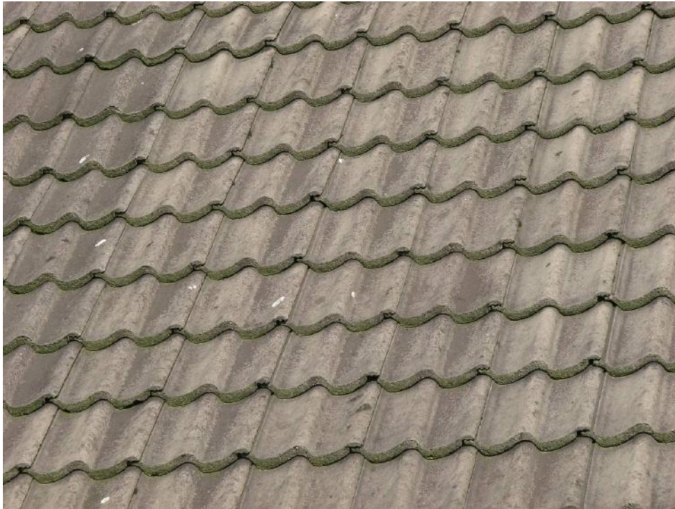
Foto 11: Door de vlakliggende pannen is het dak ongeschikt als broedplaats voor de Gierzwaluw.
