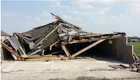
Figuur 4 Vervallen schuur.
