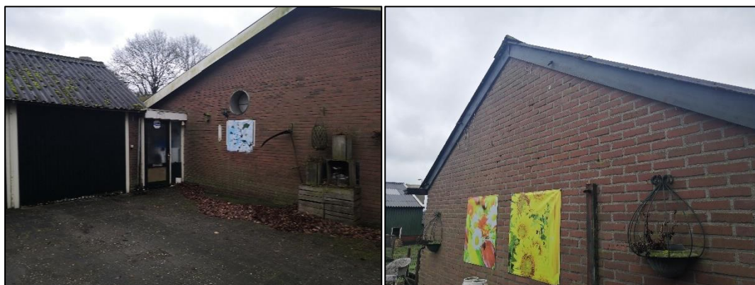
Figuur 2.5 (links): Het koppelstuk tussen de koeienstal en de garage; Figuur 2.6 (rechts): De daklijst van de garage, deze wekt een verouderde indruk. Onder de dakbedekking van de garage is geen isolatie aangebracht.
