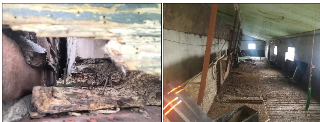
Figuur 2.11 (links): Impressie van een van de tochtgaten van de spouwmuren; Figuur 2.12 (rechts): Binnen aanzicht van de varkensstal, deze wordt al geruime tijd niet als stal maar als opslag gebruikt. Aan de linkerkant van de afbeelding is de hooischuur te zien, deze is grotendeels afgesloten met houten platen.
