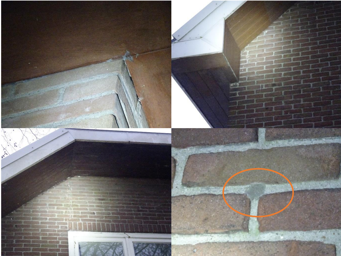
Figuur 8 Hoedanigheid van de voorgevel van het woonhuis. Het boeiboord zit nagenoeg overal strak tegen de gevel aan en de gevel is duidelijk nageïsoleerd (dichtgestopte voeg). Foto's: Bureau Biota.
