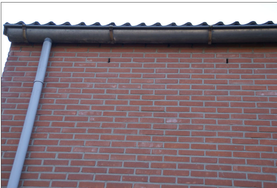
Muur met open stootvoegen onder de dakgoot
