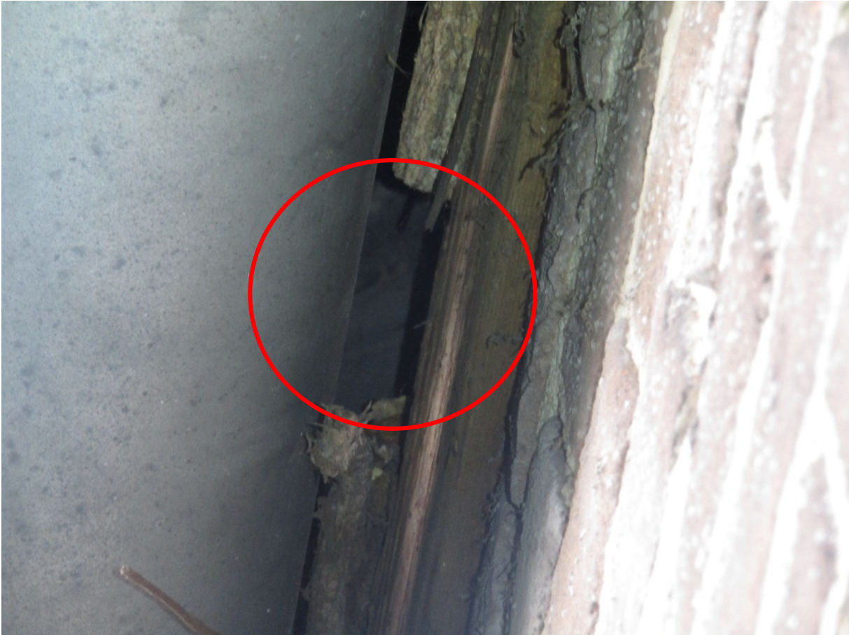
Figuur 5.10: Voorbeeld van een aanwezige kier tussen dakgoot en muur van de oude woning (nr. 148).
