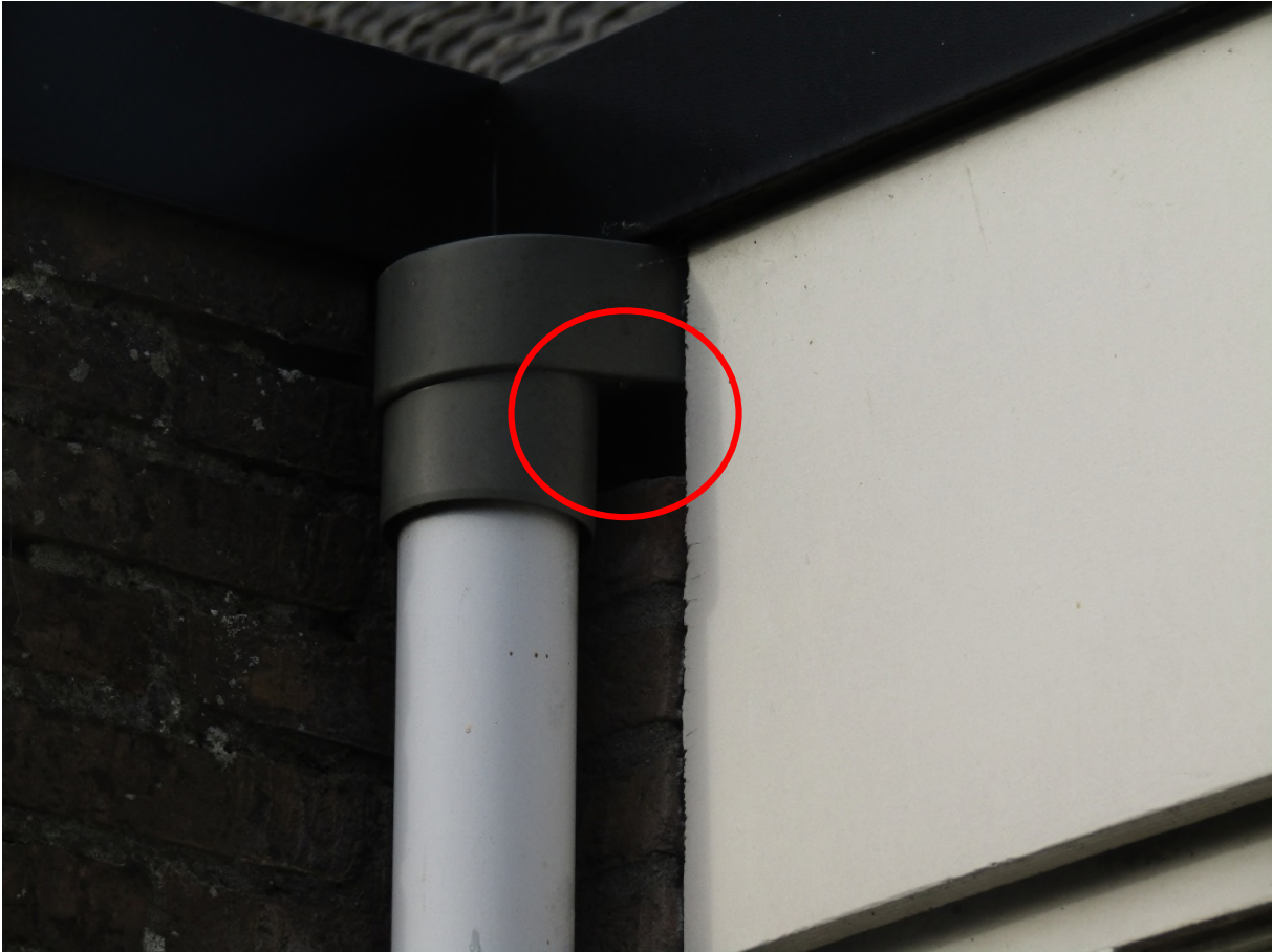
Figuur 5.12: Gat nabij de regenpijp tussen de aanhechting van het oude woonhuis en de aanbouw.
