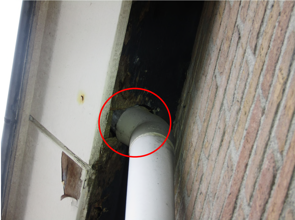
Figuur 5.17: Aanwezigheid van een opening nabij een regenpijp van het uitvaartcentrum.
