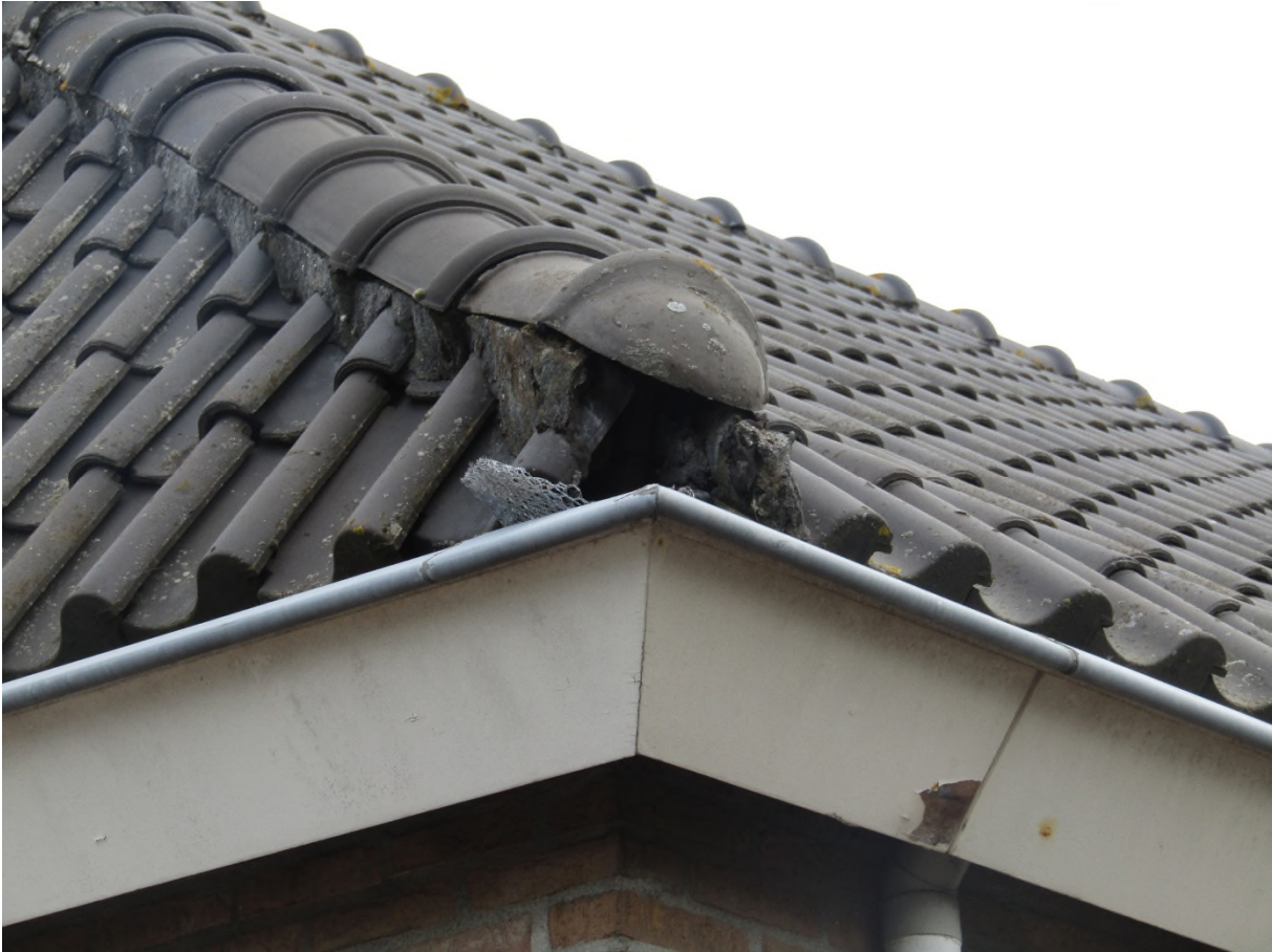
Figuur 5.4: Aanwezigheid van een opening bij het dak van het uitvaartcentrum.
