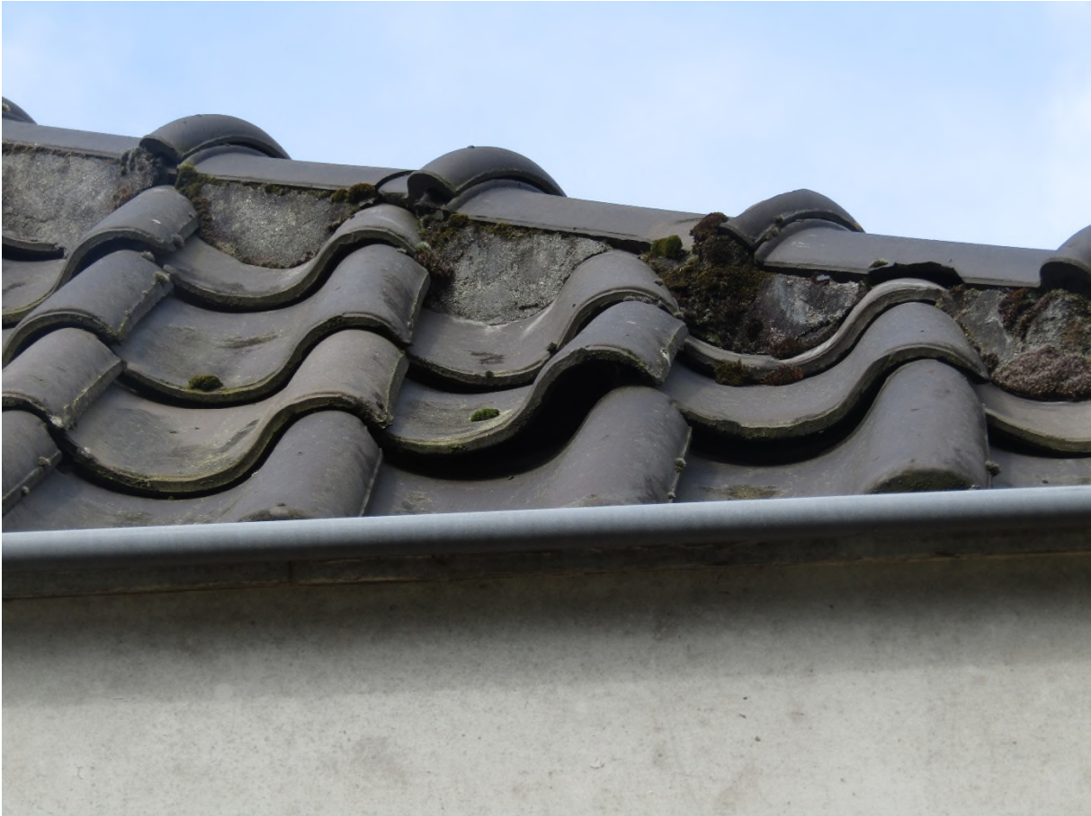
Figuur 5.3: Aanwezigheid van een opening bij het dak van het uitvaartcentrum.
