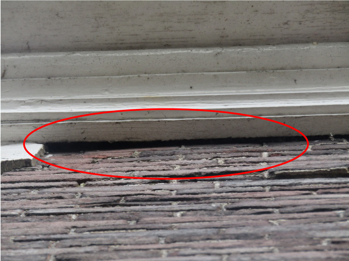
Figuur 5.9: Voorbeeld van een aanwezige kier aan voorzijde van de oude woning (nr. 148).
