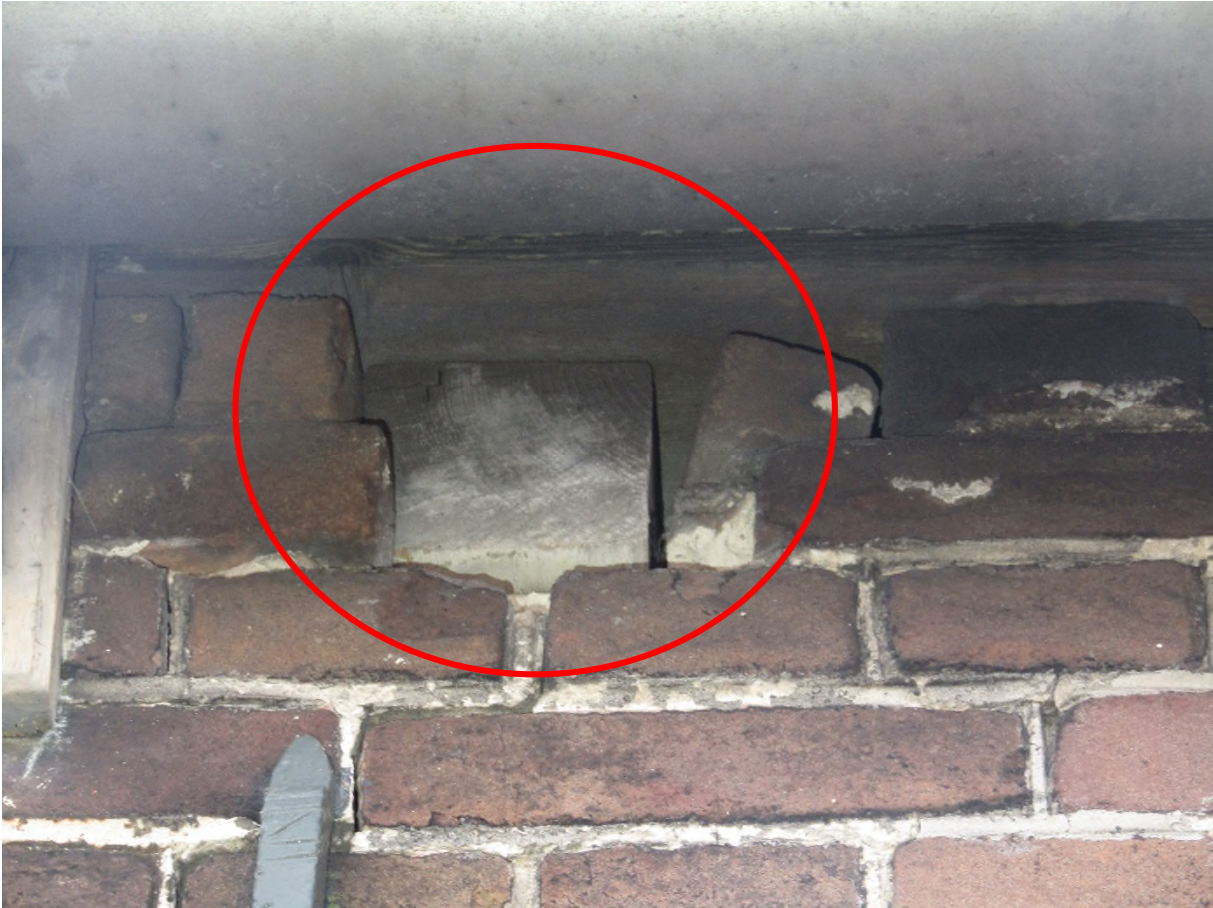
Figuur 5.11: Voorbeeld van de aanwezige gaten ter plaatse van de muur aan de zijkant van de oude woning (nr. 148).
