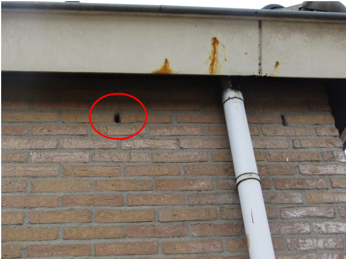
Figuur 5.15: Aanwezigheid van open stootvoegen ter plaatse van het uitvaartcentrum.
