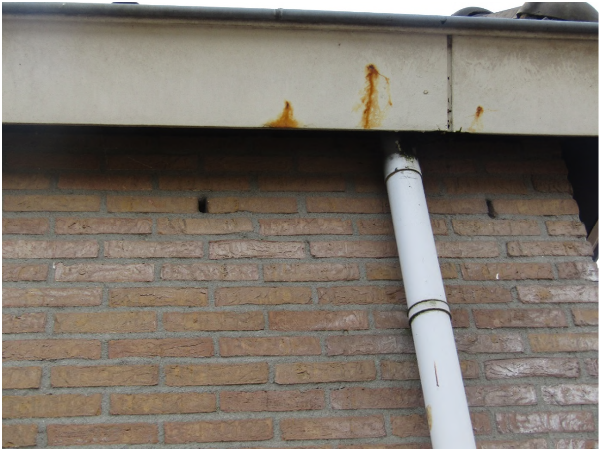
Figuur 5.6: Regenpijp ter plaatse van het gat in het boeideel van nr. 148a.
