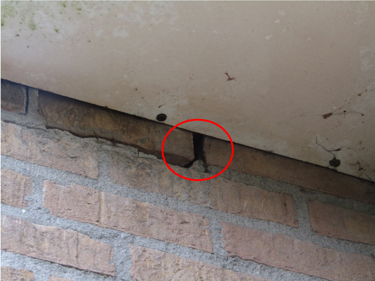
Figuur 5.16: Aanwezigheid van open stootvoegen ter plaatse van het uitvaartcentrum.
