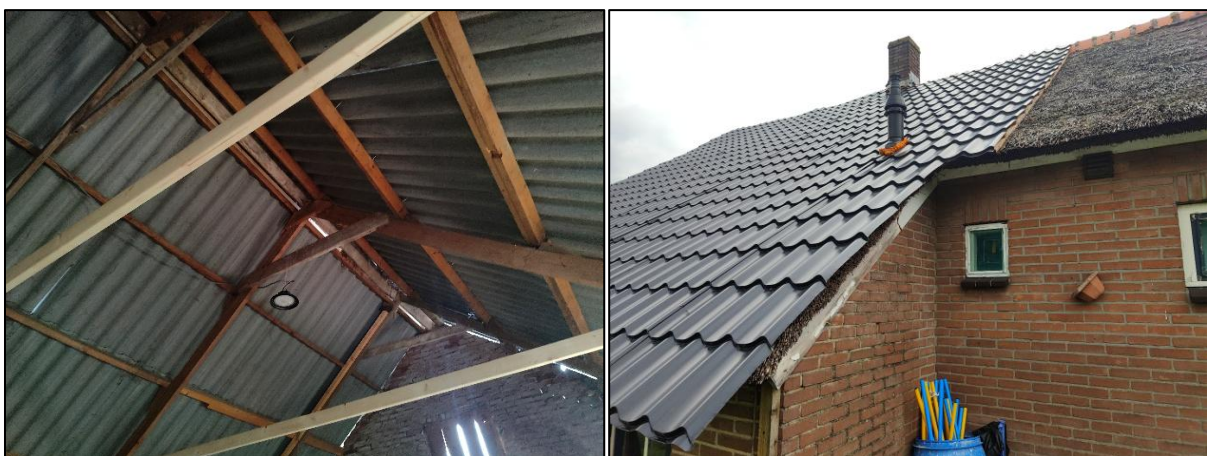
Het dak van de schuur beschikt niet over isolatie of dakbeschoot (links), de woning beschikt over een rieten dak, deels hersteld met een kunststof dakplaat (rechts).
