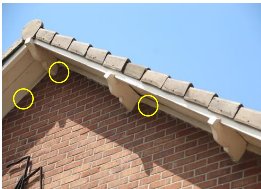
Kieren tussen de betimmering en het dakoverstek van de pastorie (gele cirkels).
