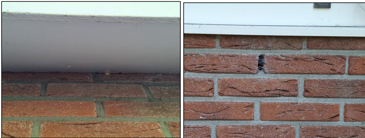
Foto links: de buitengevel en dakoverstek sluiten nauw op elkaar aan, foto rechts: open stootvoeg met spinnen rag laag bij de grond.
