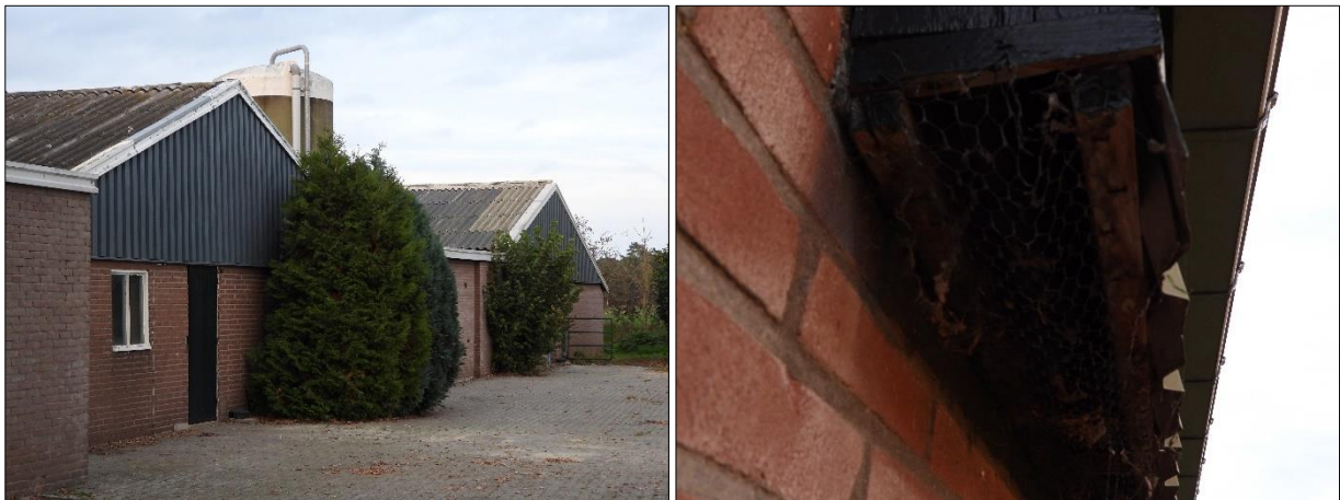
Foto links: potentiële nestlocatie van vogels in beplanting, foto rechts: vogelschroot weerhoudt vogels ervan een nestlocatie aan de bebouwing te bezetten.
