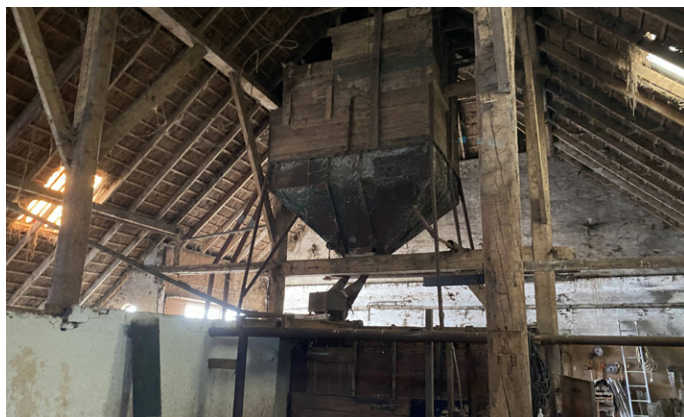
Afbeelding 5. Schuur nr. 3 was voor oorsprong voorzien van een rietendak. De golfplaten zijn direct op het riet gelegd.
