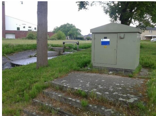
gemaal Plaggemars (locatie A5, GM00101) en stuw daarachter
