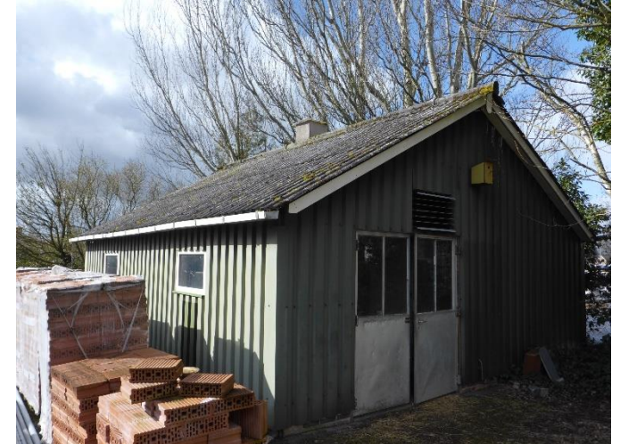
Foto 3: Asbestverdachte dakbedekking (golfplaten) (1)
