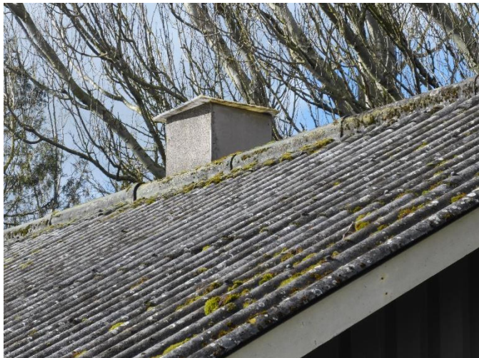
Foto 4: Asbestverdachte dakbedekking (golfplaten) (2)
