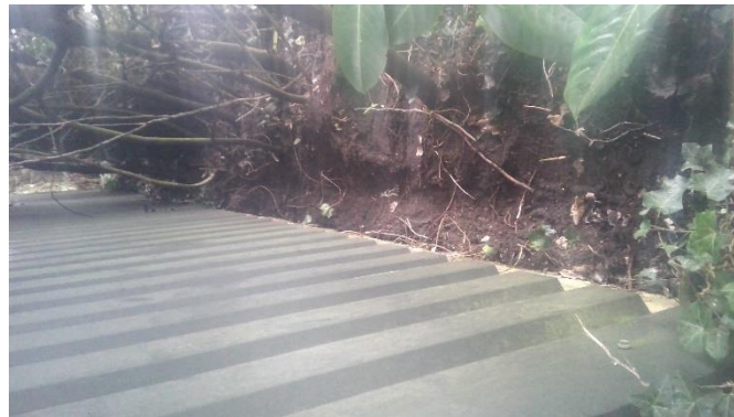
Foto 5: Asbestsleuf nr 20 (lekzone)
