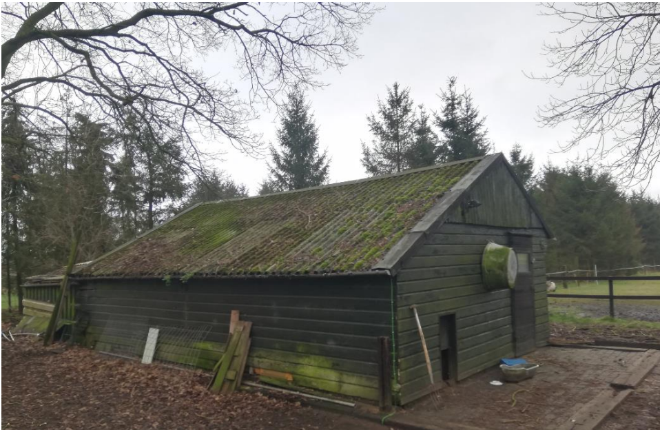
Figuur 15: Op het huidige erf staan tal van vervallen gebouwtjes
