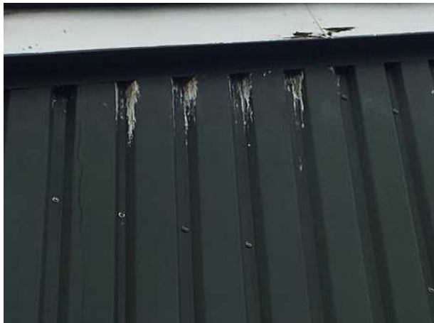
Schijtsporen van spreeuw. Dit is een aanwijzing voor een nestplaats onder de golfplaten.
