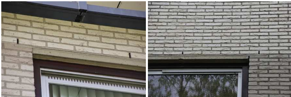
Open stootvoegen; potentiële invliegopeningen van vleermuizen in het kantoorgebouw.
