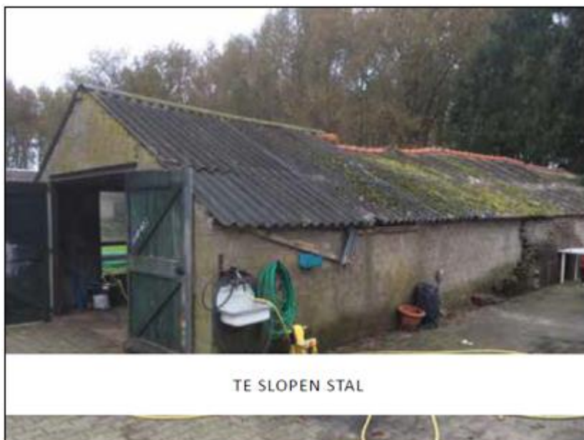
Figuur 3.1 Te slopen bijgebouw (Bron: Buro Stad+Land)
