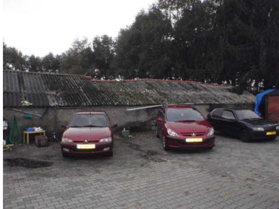
Afbeelding 4: schuur met asbest dak
