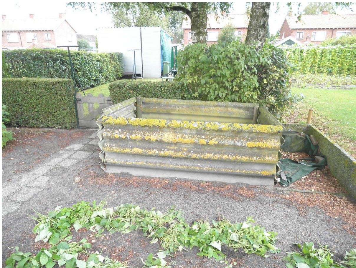
Foto 3: ingegraven mogelijk asbesthoudende beplating
