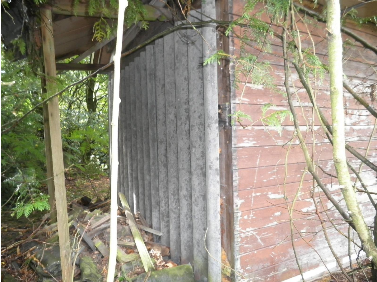
Foto 1: schuur met mogelijk asbesthoudende beplating
