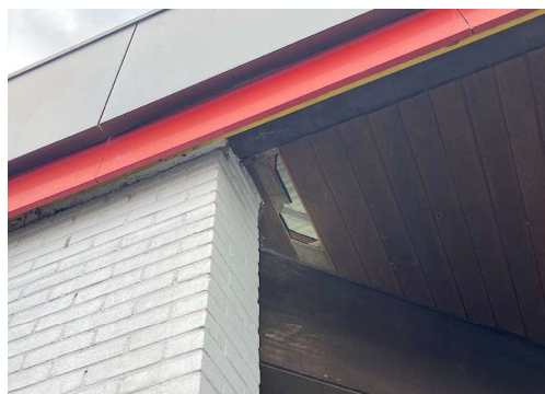
Figuur 13. Inham in de westgevel met missende plafondplank.
