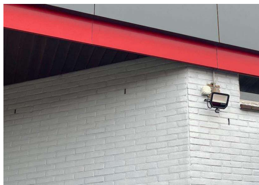
Figuur 12. Westgevel werkplaats met open stootvoegen.
