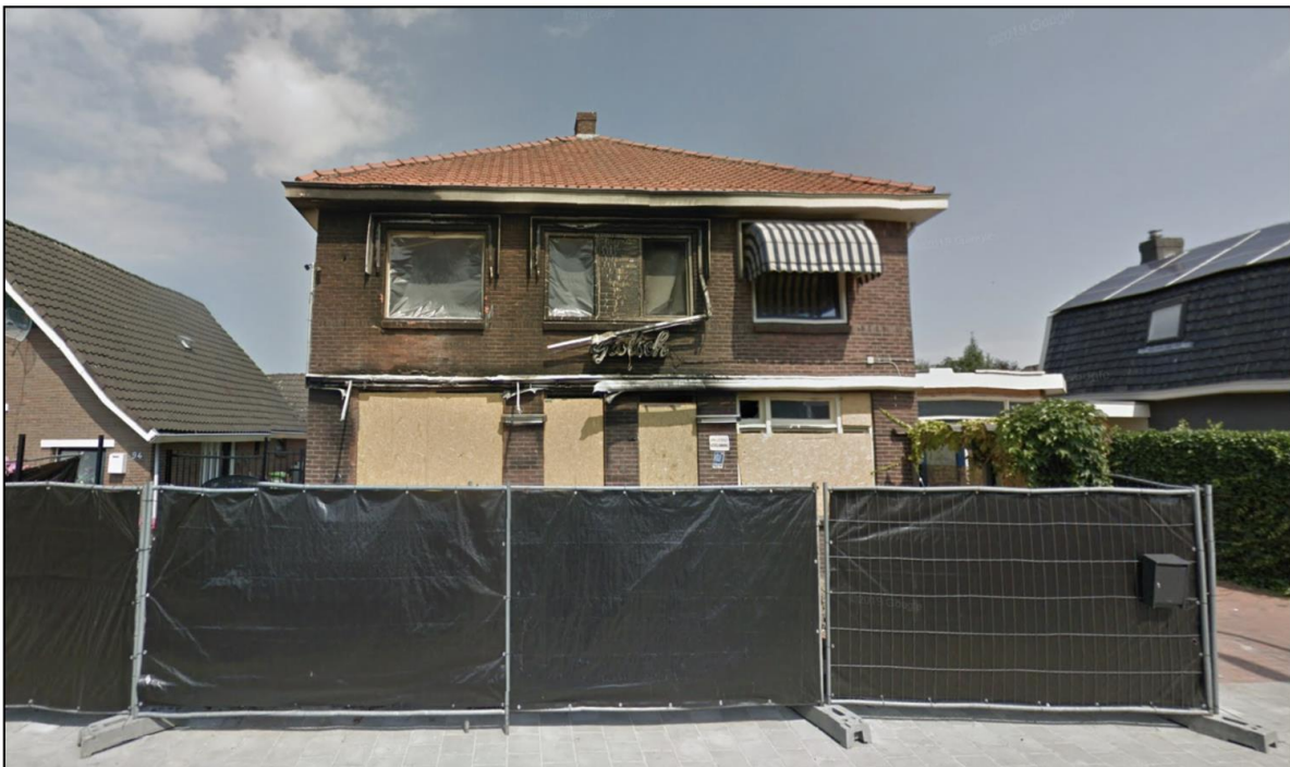
Afbeelding 2.2 Aanzicht situatie plangebied vanaf de voorzijde, na de brand in 2018 (Bron: Google Street view)
