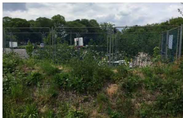
Afbeelding 11. Gastank met grondwal op terrein.
