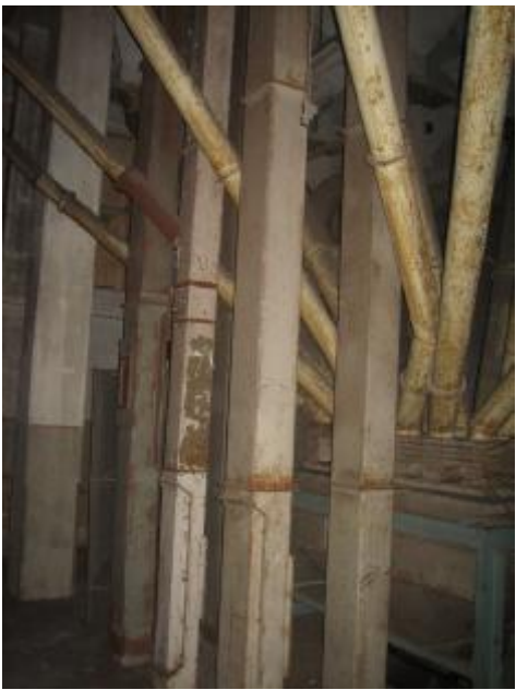
^ de menginstallatie op begane grond silo
