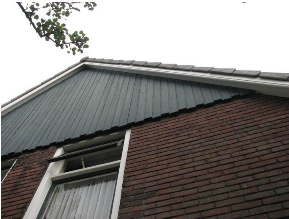
Foto 15: De betimmering aan de voorgevel bevat geen openingen waardoor vleermuizen geen toegang hebben.
