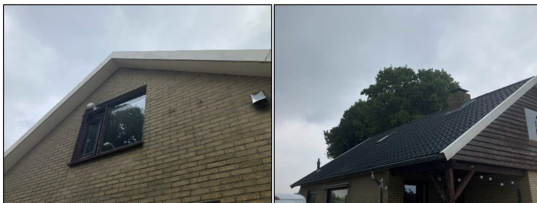
Figuur 2.5 (links): De daklijst aan de achterzijde van het gebouw; Figuur 2.6 (rechts): Een impressie van het dak.
