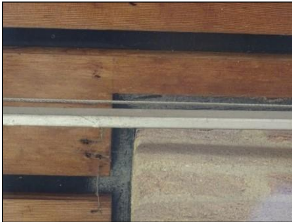
Figuur 12. Geen ruimte achter afwerking aan onderzijde dakoverstek.
