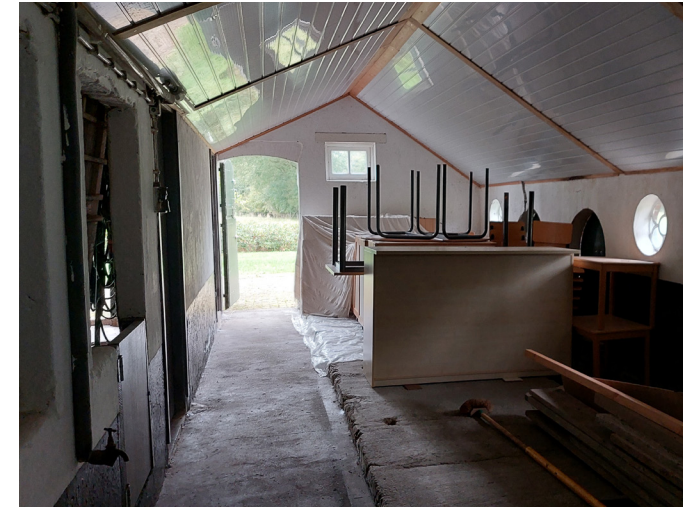
Afb. 48 Voormalige varkensstal met gaten van het hekwerk in de vloer.
