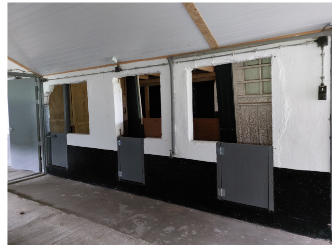
Afb. 73 Doorbraken in muur van tasruimte.
