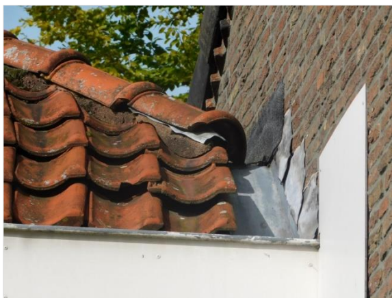
Figuur 5.1 Openingen tussen dakpannen.
