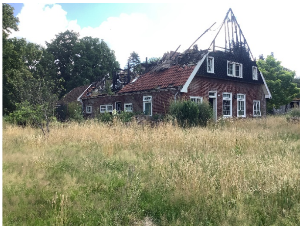
Deels afgebrande woning
